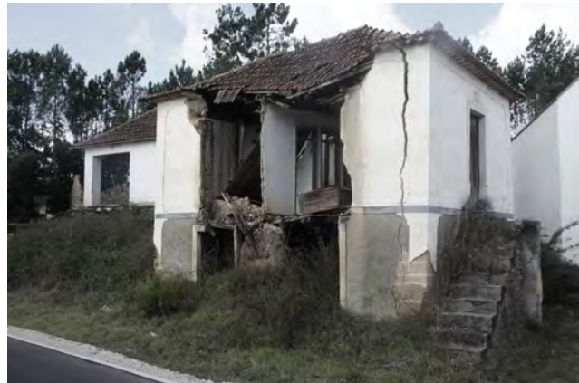
Fig. 101. Casa em ruina na aldeia de Cacinheira
