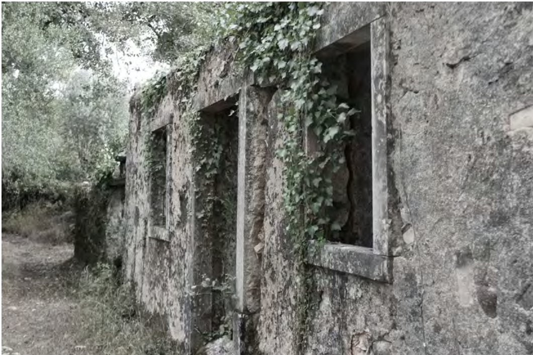
Fig. 80. Edifício devoluto a 1km antes de Anacos
