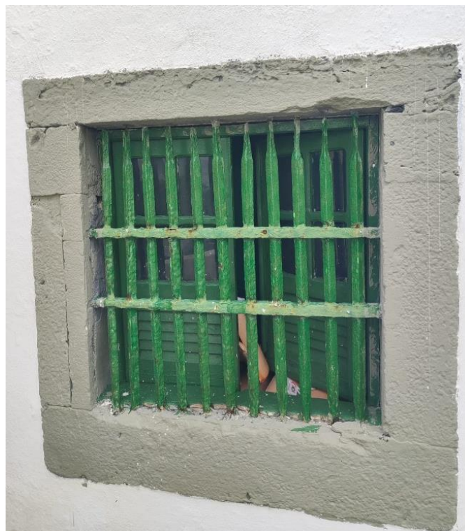
Figura B 19 - Janela do alojamento. (Fonte: SPIMA6)
