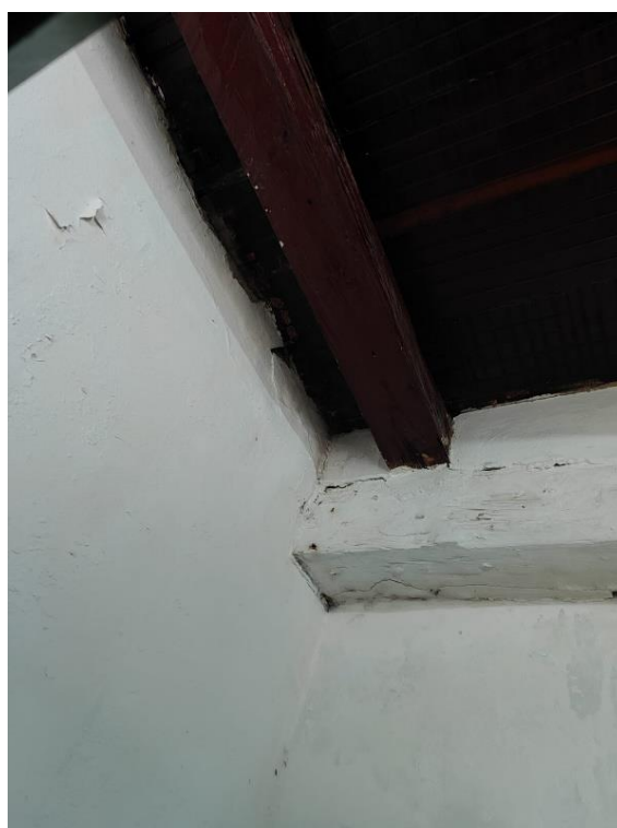
Figura B 27 - Viga com infiltração no banheiro. (Fonte: SPIMA6)
