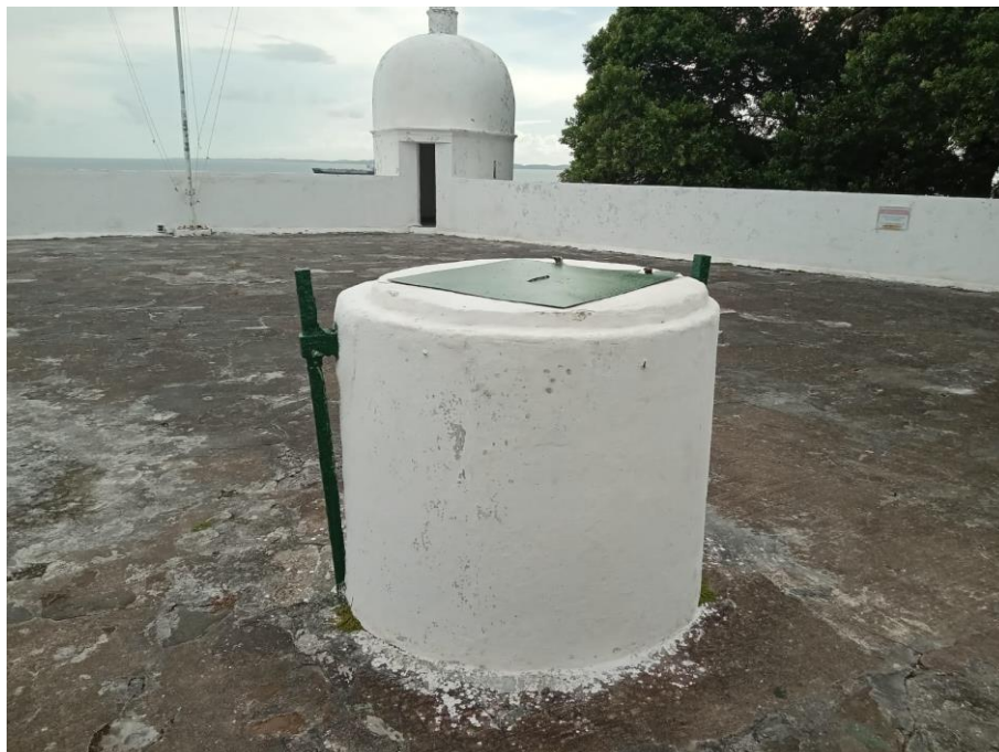
Figura B 9 - Acesso da Cisterna no terraço. (Fonte: Eng. Daiane Montenegro)
