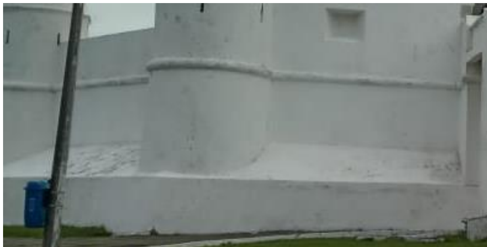
Figura B 15 - Vista externa da Muralha frontal. (Fonte: Eng. Daiane Montenegro)
