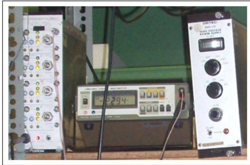
Figura 4.11 – Fontes de alta tensão utilizadas (Luís, 2010).
