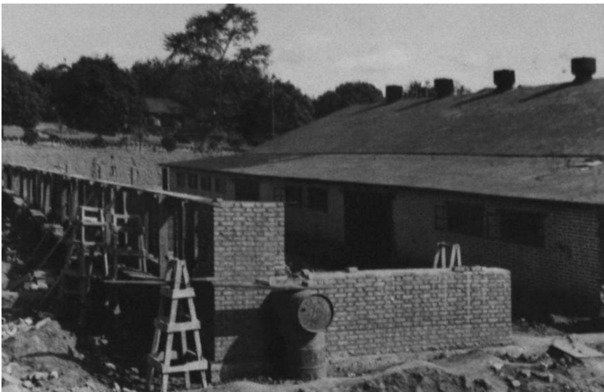
Aspectos da construção da Oficina para a SMMM [Construção e reparação de edifícios, 1950-53. UC/AD]
