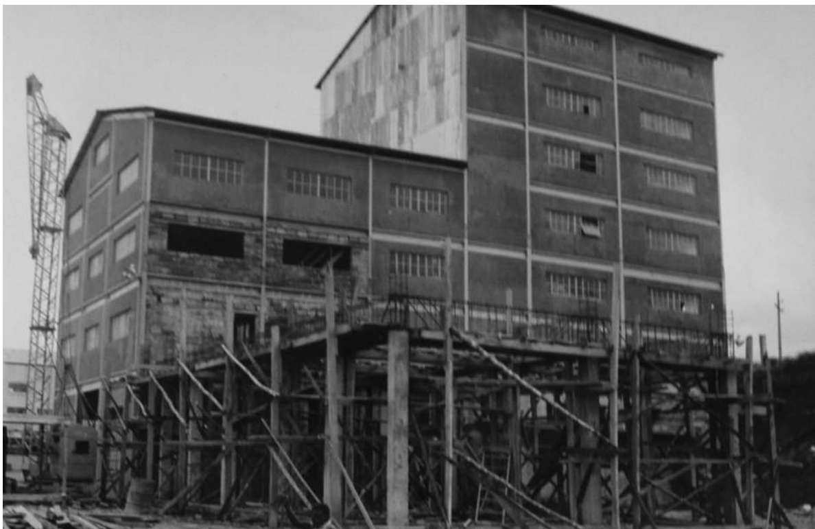
Instalação de Separação Gravítica em Meio-Denso nº2. Anexos à Estação de Escolha [Relatório Anual da DSOVC, 1967. UC/AD]
