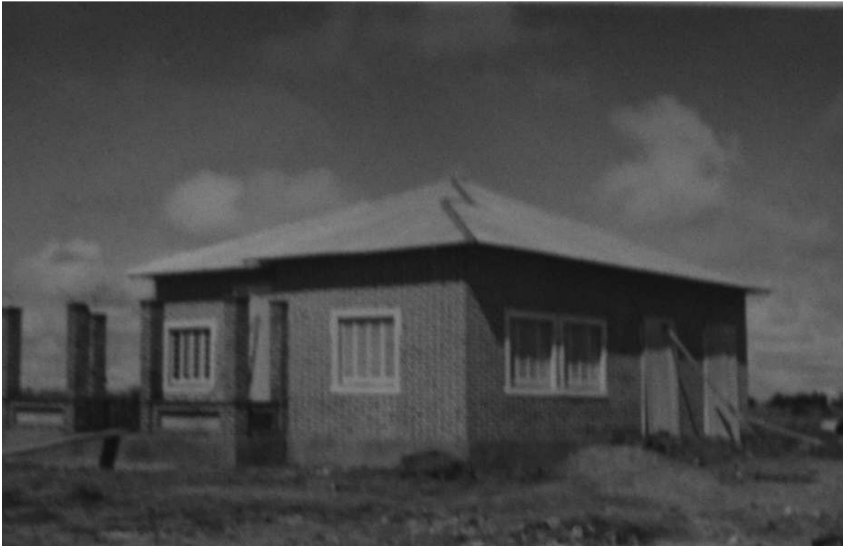
Canzar. Hospital-Dispensário. Um aspecto da construção [Construção e Reparação de Edifícios, 1950-53.UC/AD]
