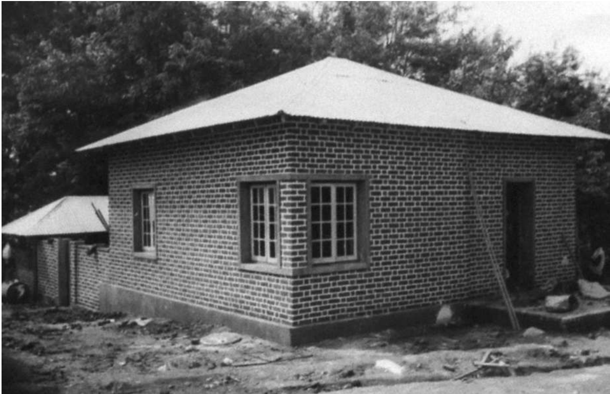
Casas simples para assimilados. Novo tipo de habitação [Construção e Reparação de Edifícios, 1950-53. UC/AD]
