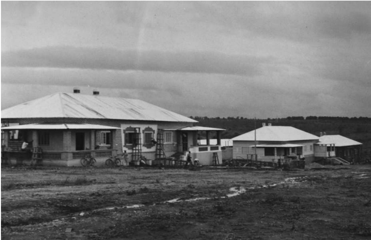
Conjunto de casas de habitação para empregados, em Andrada (construção) [Relatório do Serviço de Construção Civil, 1960-63. UC/AD]
