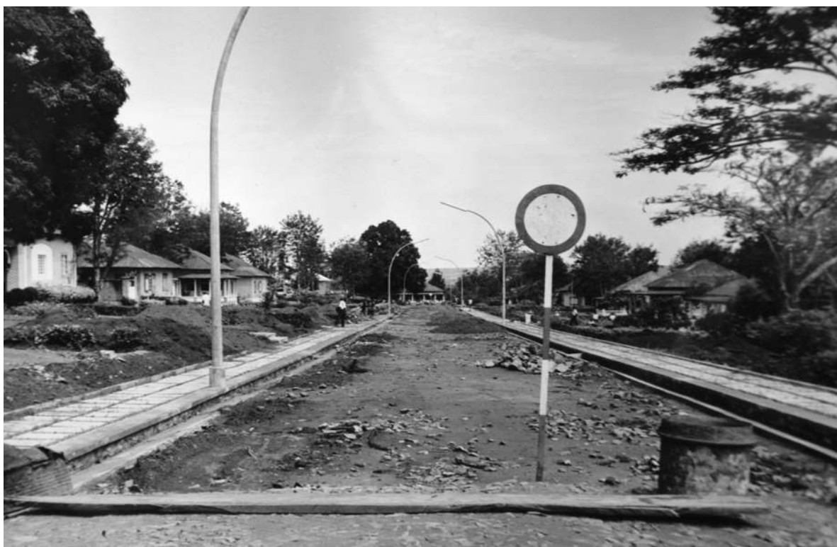
Rua 8, durante os trabalhos de remodelação [Relatório Anual da Concessão do Dundo, 1964. UC/AD]
