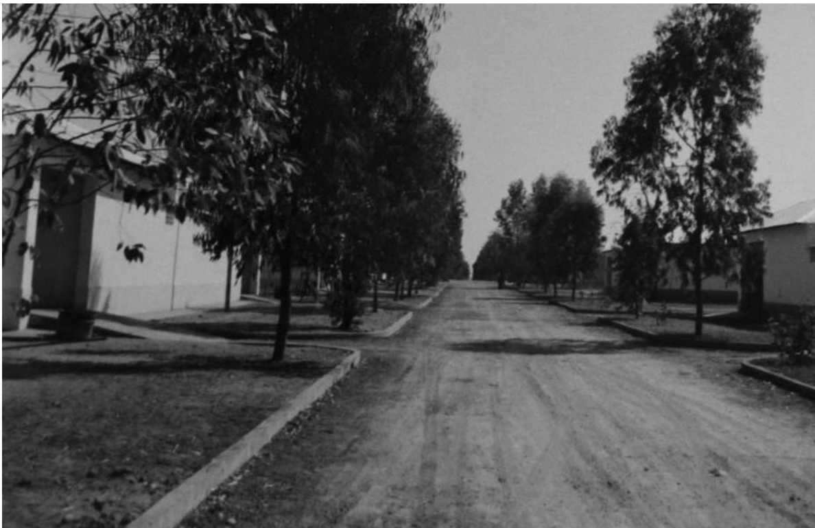
Rua de serviço depois de concluída com esgotos, lancil, sargetas e preparada para alcatroamento [Urbanização e Saneamento da Lunda, 1967-69. UC/AD]
