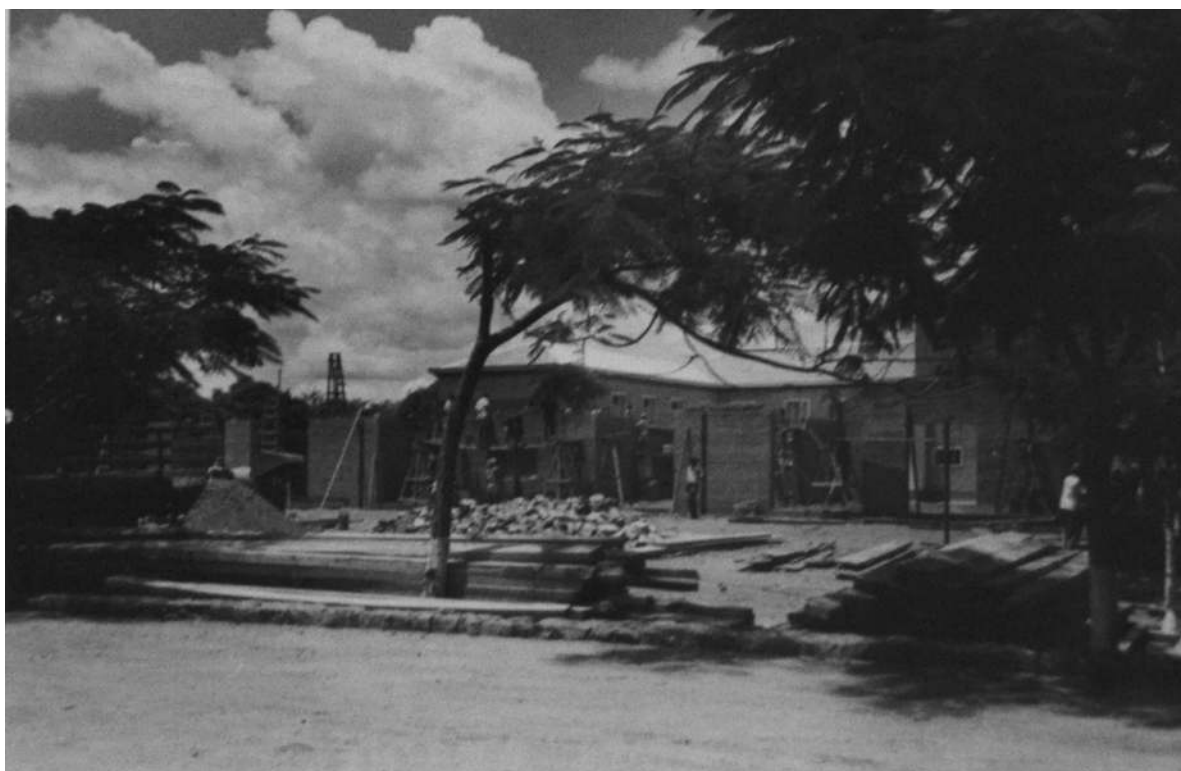
Casa do Pessoal, Dundo. Corpo da biblioteca (em construção), 1951 [Construção e Reparação de Edifícios, 1950-53. UC/AD]
