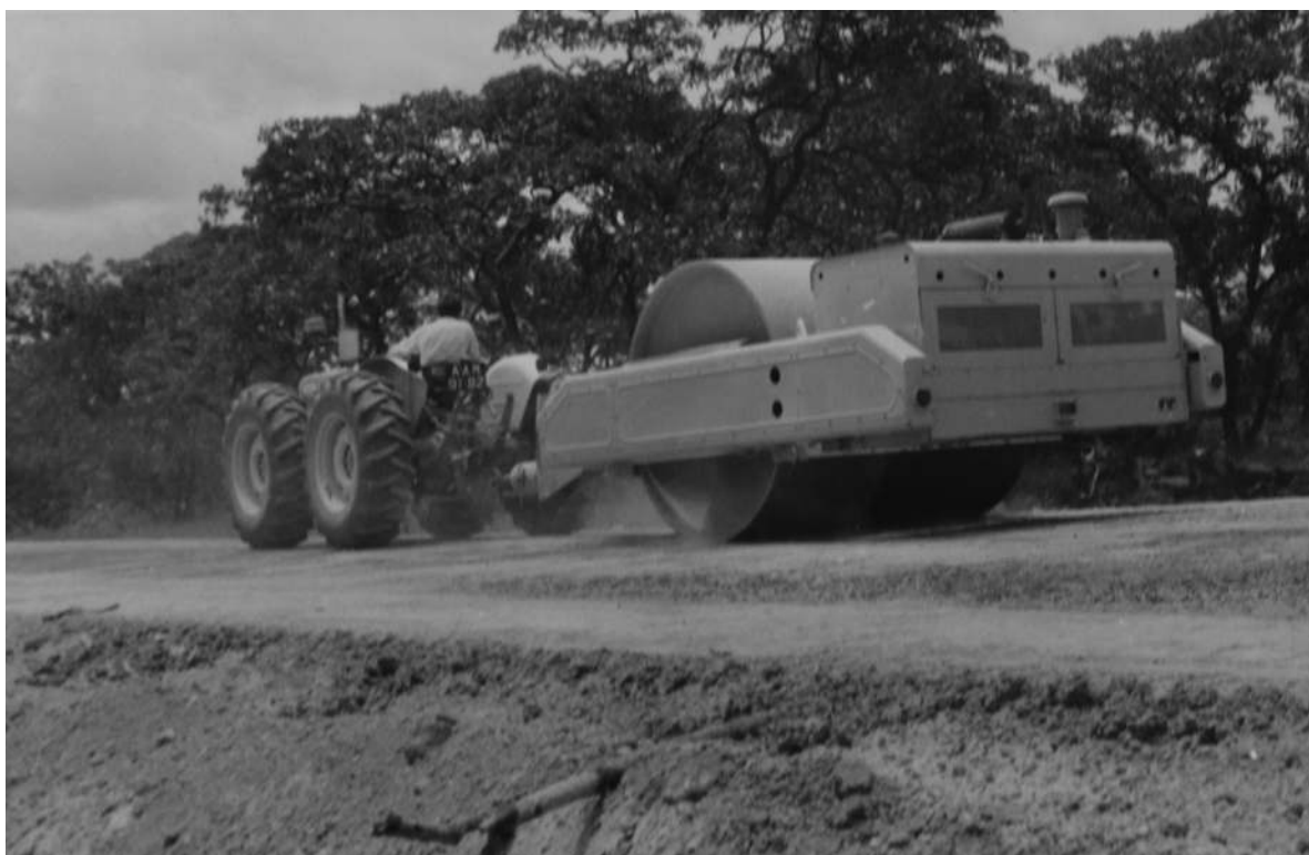
Estrada Luzamba-EN Malange/Henrique Carvalho. Estabilização dos terraplanos [Relatório Anual da DSOVC, 1967. UC/AD]
