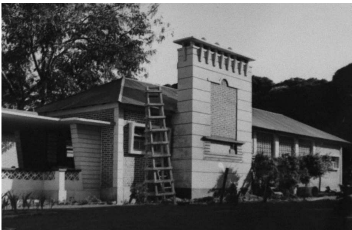
Casa da Representação. Aspecto das trabalhos nos novos anexos. Lado norte [Construção e reparação de edifícios, 1950-53. UC/AD]
