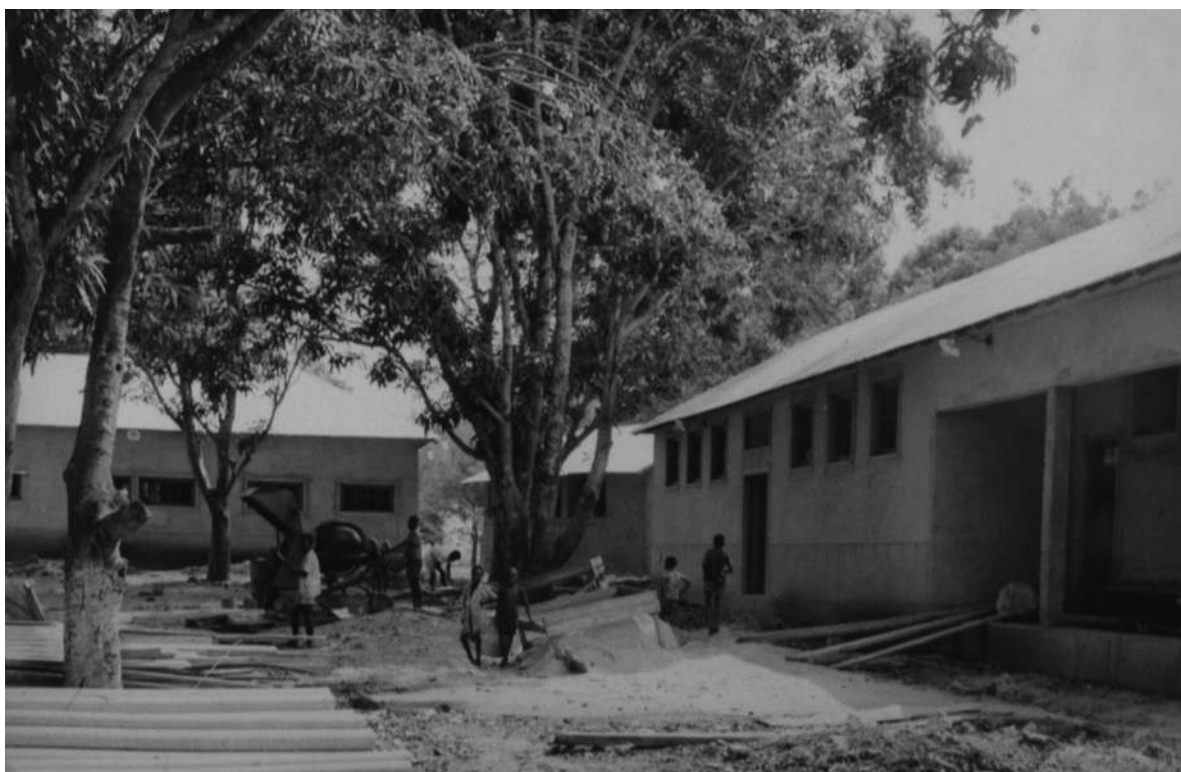
Aquartelamento do Lóvua. Cozinha-Refeitório e Parque Auto [Construção e Reparação de Edifícios, 1964-65. UC/AD]
