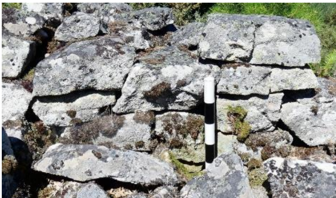
Figura 42 – Face interna da muralha de Vilarelho, aparelho irregular com vértices e arestas “vivas”
