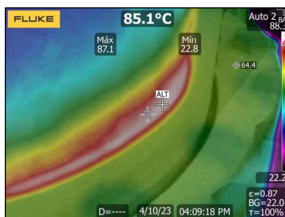
Figura 3.4 – Imagem termográfica de exaustão da tremonha de aparas.
