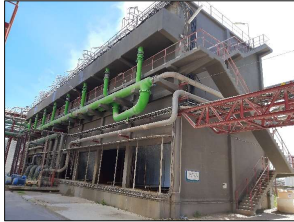
Figura 6.2 - Torre de refrigeração geral
