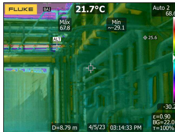
Figura 6.4 - Medição de temperatura à saída da torre de refrigeração geral
