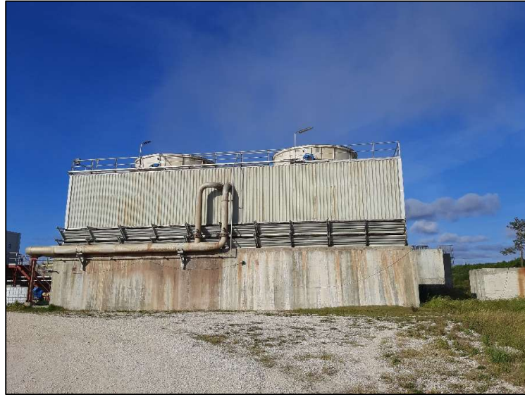
Figura 6.5 - Torre de refrigeração dos efluentes líquidos
