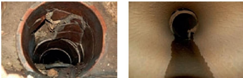
Figura 14 - Anomalias detetadas por inspeção visual (Almeida & Cardoso, 2010).
