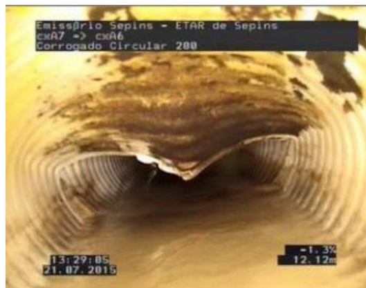
Figura 5 - Deformação no coletor devido à remoção ou depósito de terras (França, 2018).
