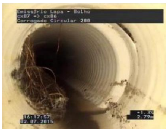
Figura 4 - Impacto na junta do coletor devido a raízes (França, 2018).
