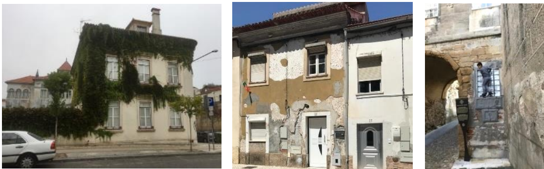
Figura 4 – Agentes de degradação – vegetação, manutenção e vandalismo.
