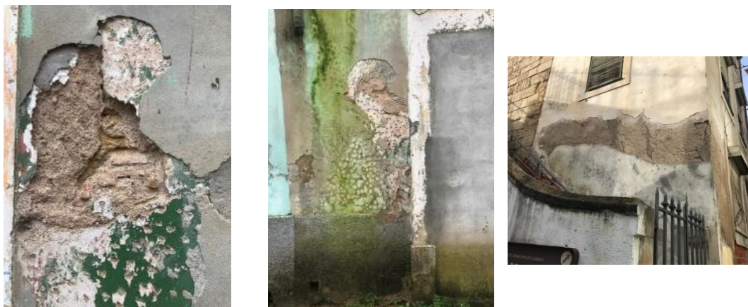
Figura 3 – Agentes de degradação: Incompatibilidade de materiais, ação da água e sais solúveis.
