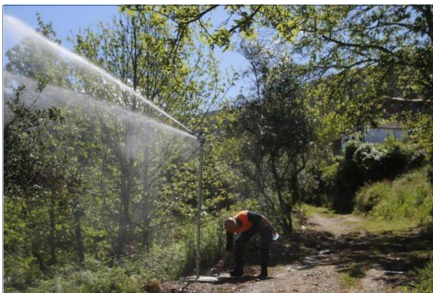
Figura 1.5. Aspersores instalados na aldeia de Travessas, concelho de Arganil [11]
