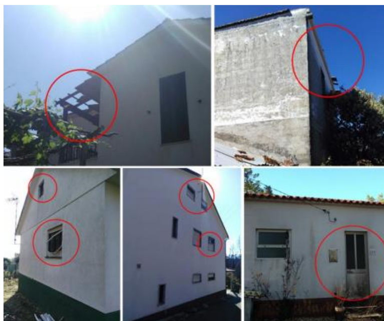
Figura 2.11. Exemplos de Elementos com alguns danos, sem ignição do edifício [34]
