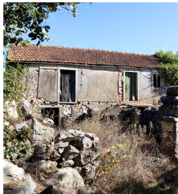
Figura 63. Edifício em ruína. Ariques. 2022
