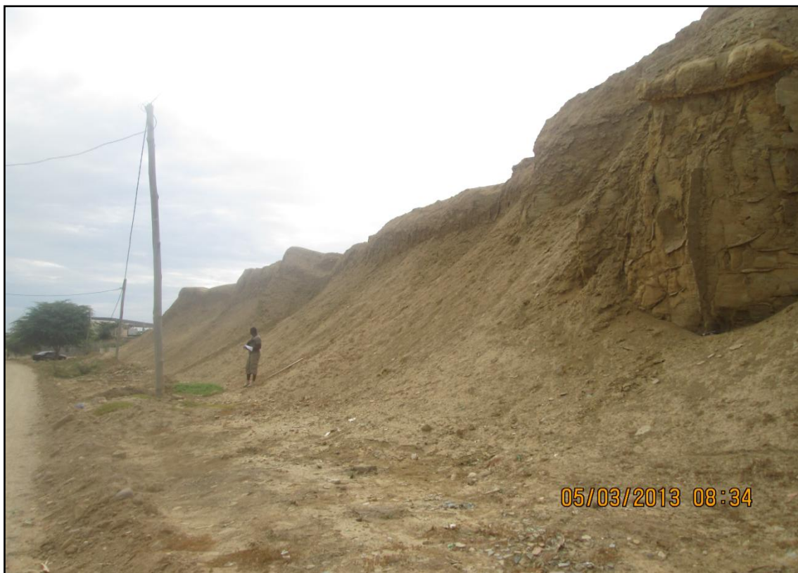
Figura 5.1 -. Primeiro talude a ilustrar os problemas de instabilidade.
