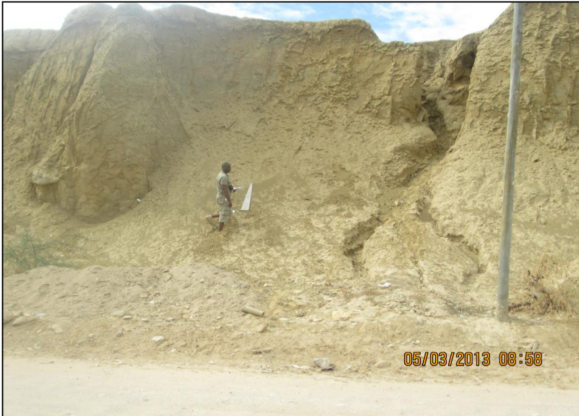
Figura 5.3 - Instabilidade presente no talude descontinuidade, linha de água, escarpa, erosão e as características do material da área.
