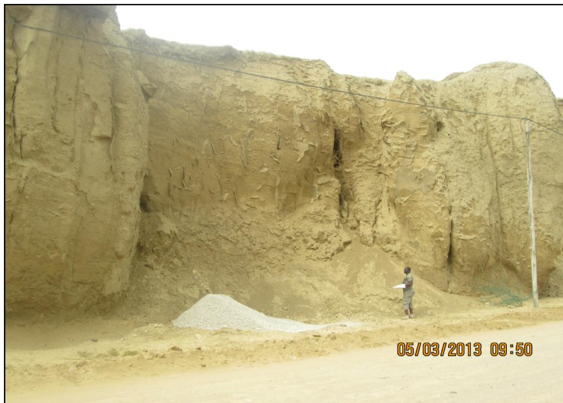
Figura. 5.5 - Instabilidade de talude, descontinuidade, escarpa, diáclases, ravina e a acção humano.
