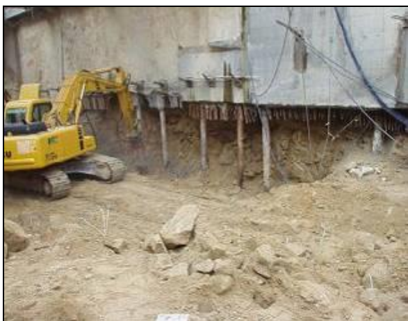
Figura 1.10 – Recalce da parede moldada na Estação 24 de Agosto, Metro do Porto (Conceição et al., 2006)
