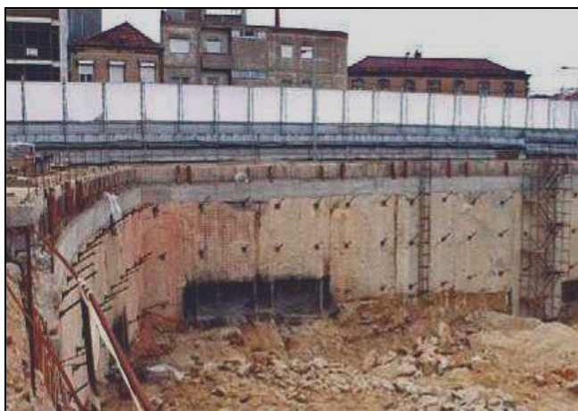
Figura 1.11 – Parede moldada executada nas obras da Casa da Música, Porto (Viana da Fonseca em 28-4-2000)
