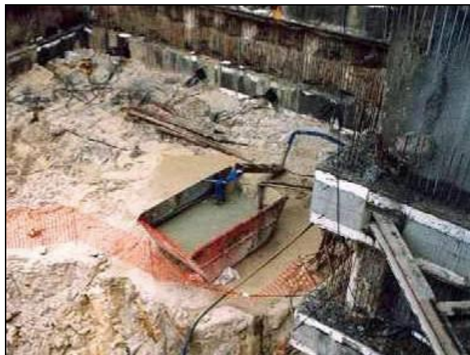
Figura 1.23 – Bombagem de água na Estação dos Aliados, Metro do Porto (Viana da Fonseca em 19-2-2003)
