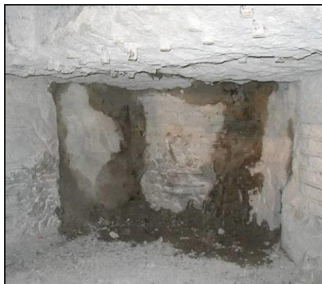
Figura 1.8 - Fotografia da base de uma cortina de estacas secantes em que devido à inclinação das mesmas se verificou a entrada de água na escavação
