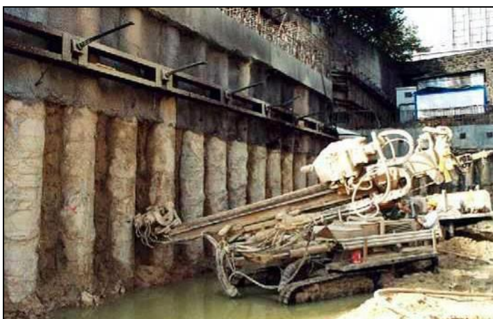
Figura 1.5 – Cortina de estacas na Estação da Trindade, Metro do Porto (Viana da Fonseca em 24-10-2002).
