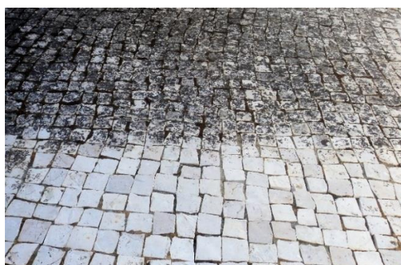
Figura 2.13 – Calçada onde é notória a diferença entre uma parte que já foi limpa e a outra onde está totalmente colonizada por matéria orgânica.
