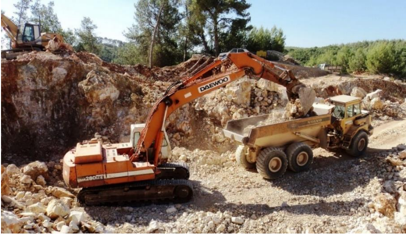
Figura 3.4 – Carregamento da matéria-prima num dumper , para ser transportada e colocada à disposição dos operários para esquadrejamento.
