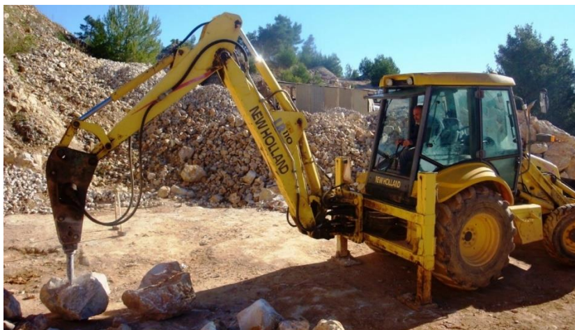
Figura 3.5 – Fracturação de um bloco de calcário com recurso a martelo hidráulico, acoplado na lança de uma retroescavadora.
