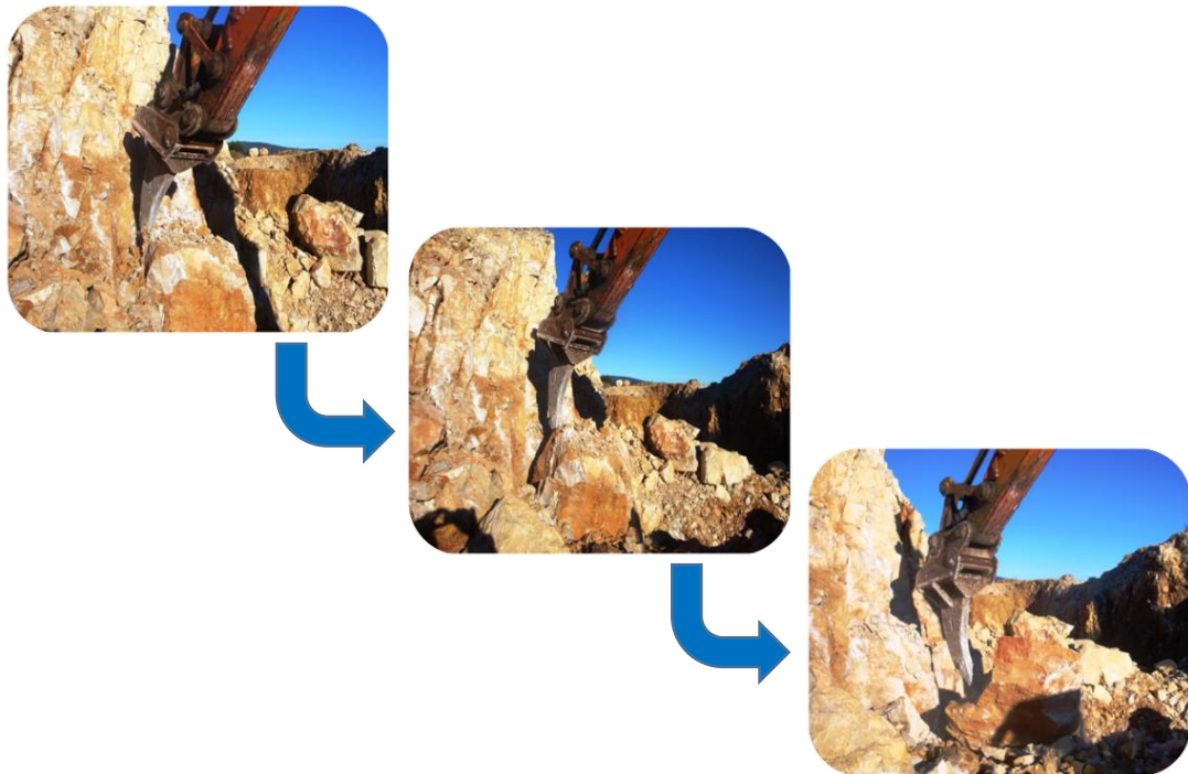
Figura 3.2 – Desmonte mecânico do maciço calcário com recurso de um ripper , onde se evidencia o arranque de um bloco por uma descontinuidade.
