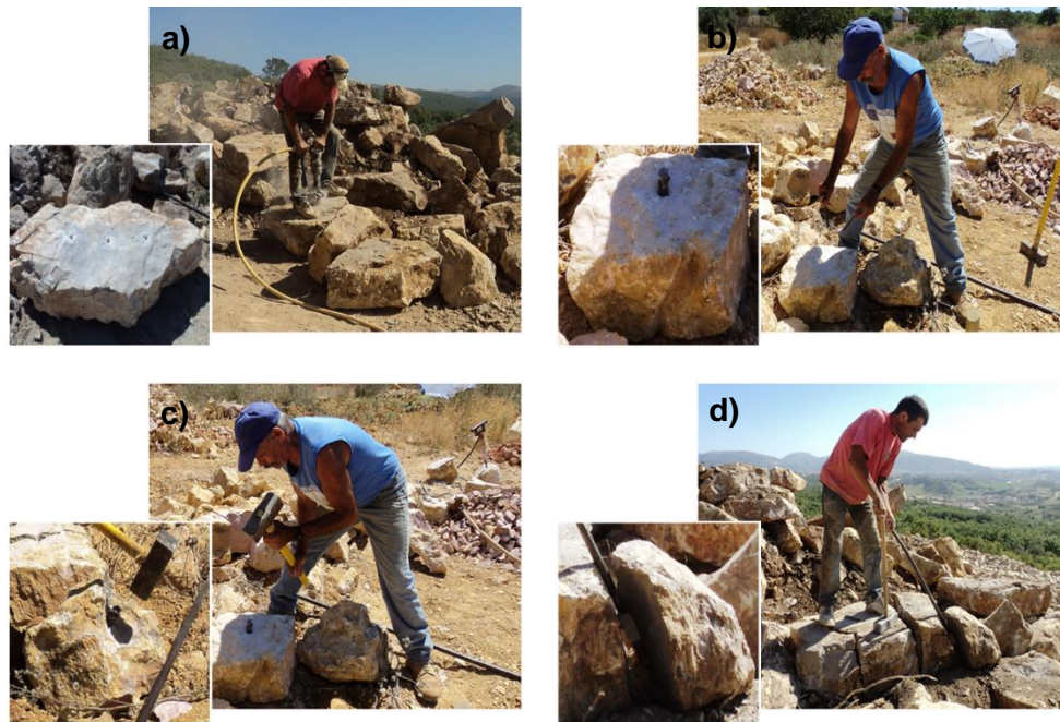
Figura 3.6 – Técnica de corte de blocos de calcário com recurso a cunhas: a) Realização dos furos; b) Colocação da cunha; c) Percussão da cunha; d) Separação dos blocos.
