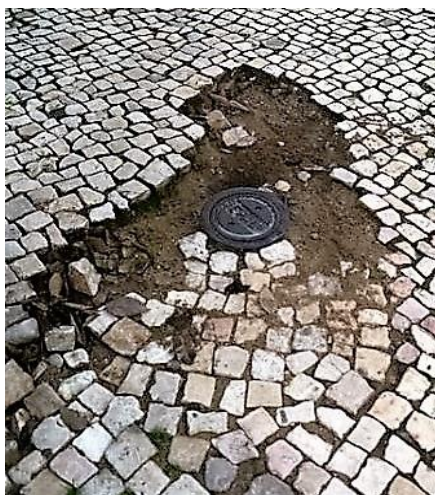
Figura 2.11 – Exemplo de um pavimento em calçada onde se conjugam várias imperfeições: 1 – arranque das pedras sem que se tenha feito a respectiva reposição; 2 – é evidente que a zona inferior da fotografia já tinha sido restaurada, mas desrespeitando o padrão do assentamento original; 3 – juntas entre as pedras demasiado largas.
