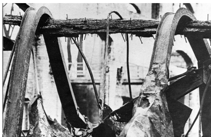
Figura 2.2 – Estrutura após situação de incêndio. Comparação entre os elementos de aço e madeira.
