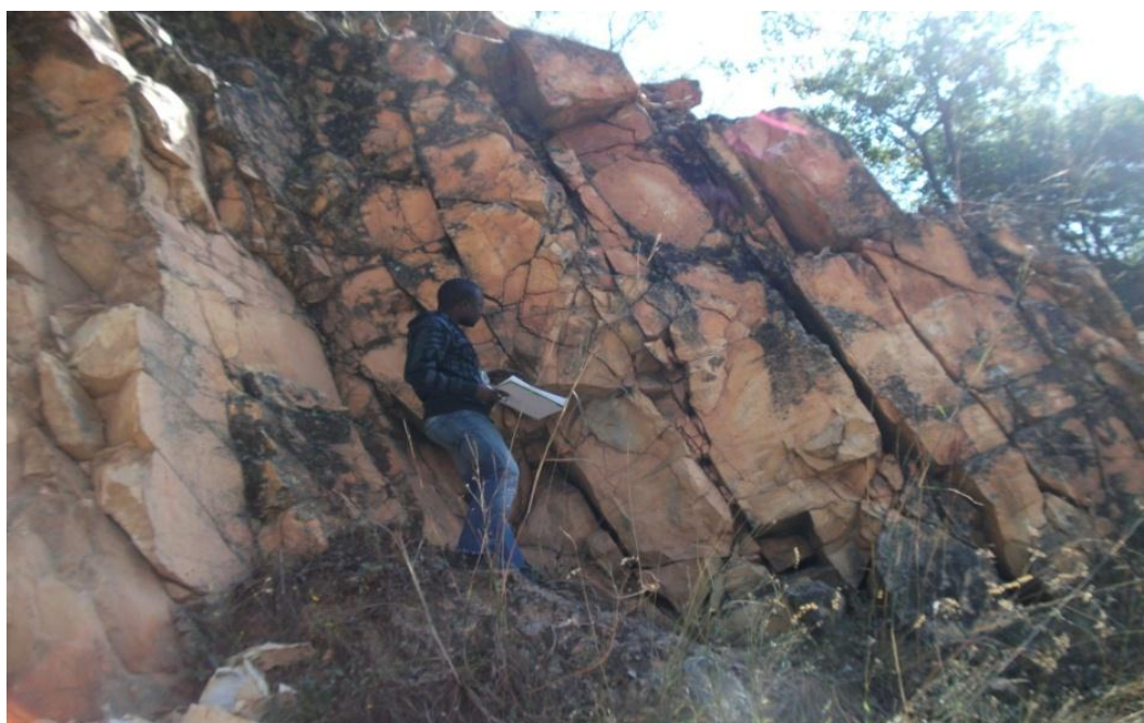
Figura 5.4 – 2º Troço do Talude1, quartzo-arenitos com discontinuidades sem material de preenchimento nas discontinuidades.
