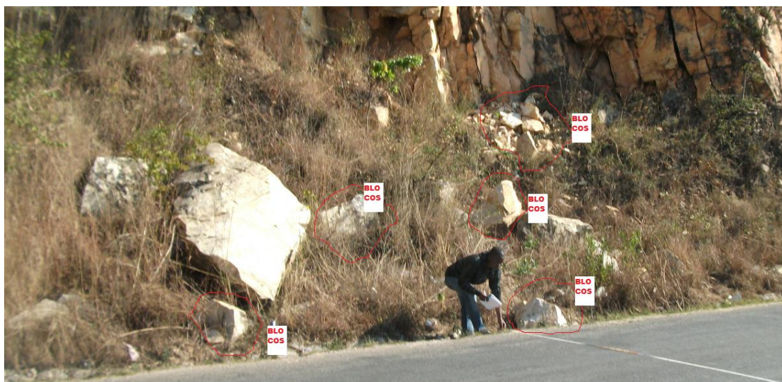
Figura 5.3 - Quedas de blocos rochosos, alguns movimentos ocorreram no ano de 2011 (2º Troço do Talude 1).
