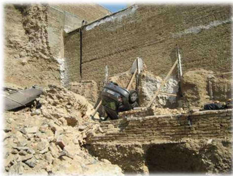
تصویر (۱-۲) تخریب به علت عمق زیاد گود
