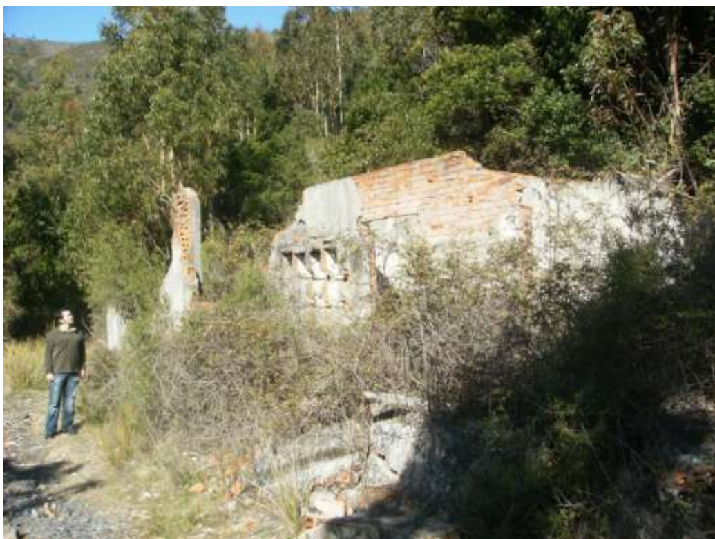
Fig. 3.3 – Edifício anexo a exploração da mina da Escádia Grande em elevado estado de degradação (março, 2013).
