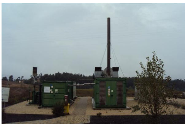
Figura 2.4- Motor gerador de energia.
