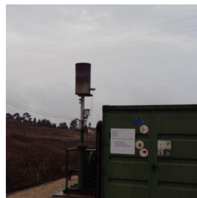
Figura 2.5- Queimador de biogás.
