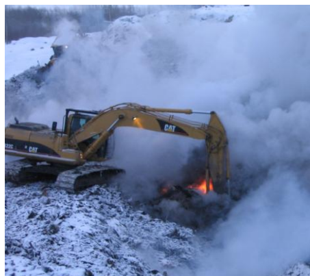
Figura 2.12- Incêndio de superfície num aterro nos Estados Unidos, 2002.
