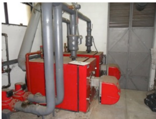
Figura 5.7 – Caldeiras Roca tecno para preparação de AQS e climatização do pavilhão III.
