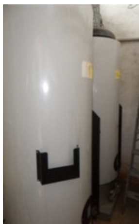
Figura 5.5 - Termoacumuladores a gás para preparação de AQS no pavilhão I.
