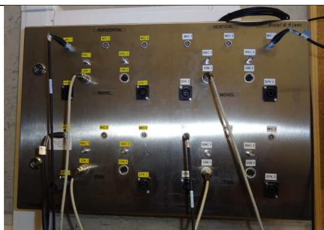
Figura 3.11 - Caixa de receção da sala de controlo
