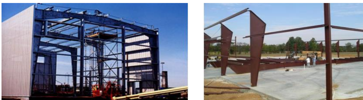
Figura 1.3 - Armazéns com vigas e colunas de secção variável (O&GO@, sem data) e (ASB@, sem data).
