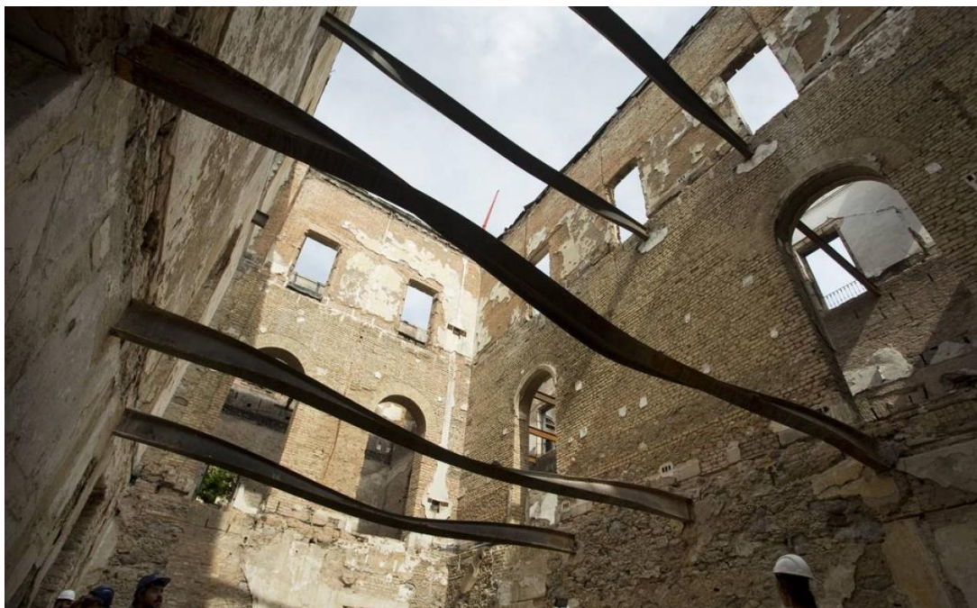
Figura 2.21 - Vigas em ferro retorcido que funcionava o salão do auditório do museu. Márcia Foletto / Agência O Globo, 2019. Disponível em: < https://oglobo.globo.com/saude/ciencia/museu-nacional-itens-do-acervo-que-se-pensavam-perdidos-sao-resgatados-23447126 >
