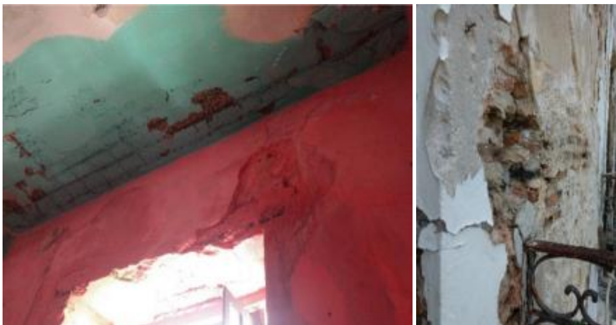
Figura 4.9 e 4.10- Perda do material de revestimento da alvenaria e corrosão das armaduras da laje de concreto armado e degradação da parede do Sec. XVII (Silva, 2018).
