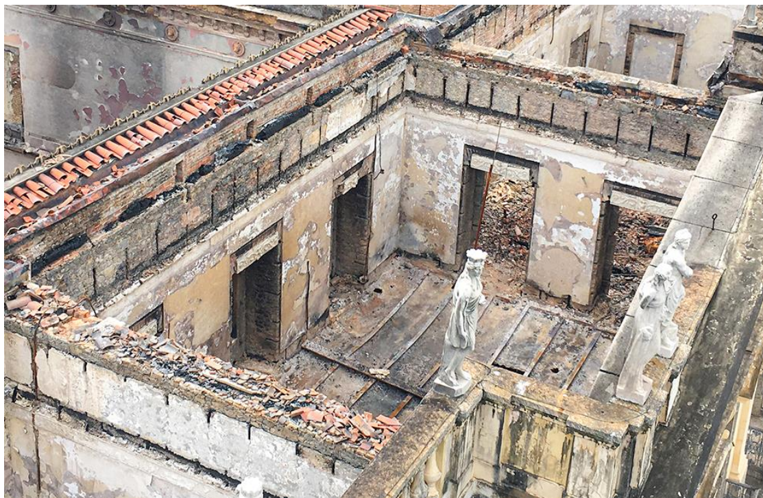
Figura 2.19 - Destruição da cobertura do Museu Nacional após incêndio, Veja Rio (Capobianco, 2020).
