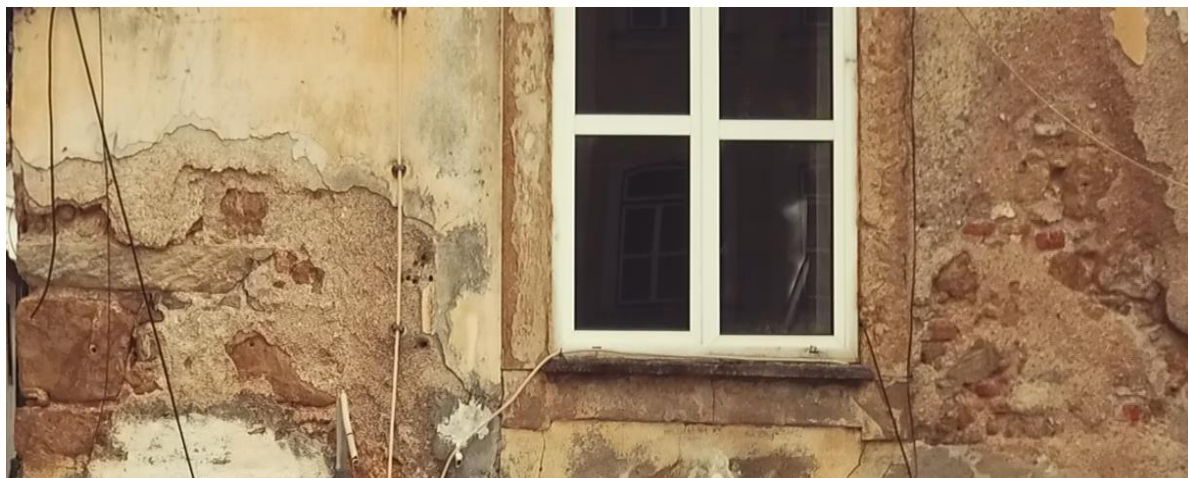
Figura 26: Materiais e assentamento irregular das paredes de alvenaria da Baixa de Coimbra
