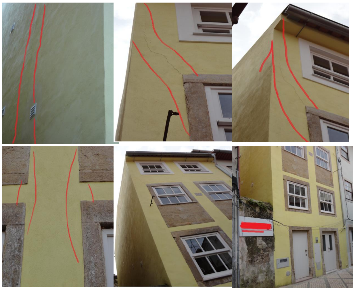
Figura 25: O cunhal do edifício não é travado, Edifício recém “reabilitado”, RMO06
