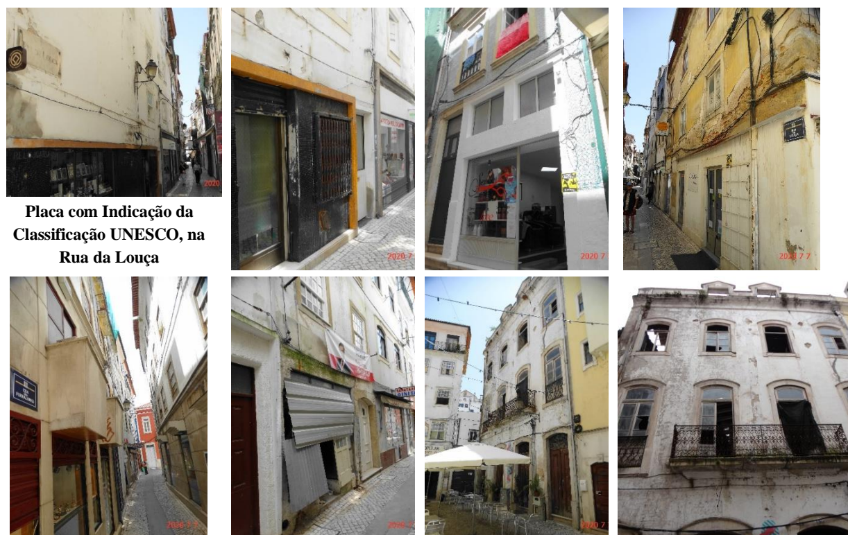
Figura 5: Descaracterização, obras paralisadas, degradação e risco de colapso. Rua da Louça, Rua da Fornalhinha e Largo da Freiria, a 7 de julho de 2020
