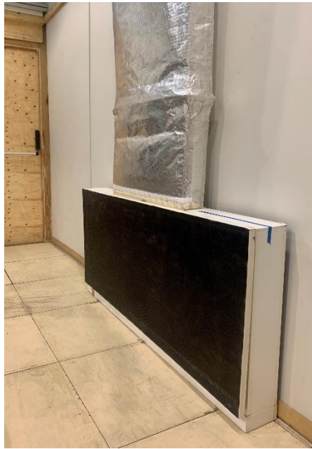
Figura 13 - Difusor de ar presente na sala de testes da CC.
