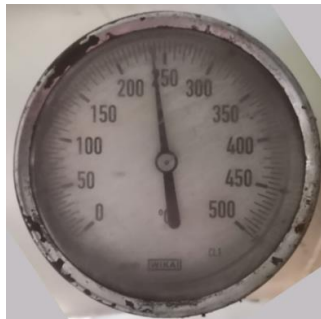
Figura 4-3 Termómetro redondo situado na saída dos gases de combustão da caldeira
