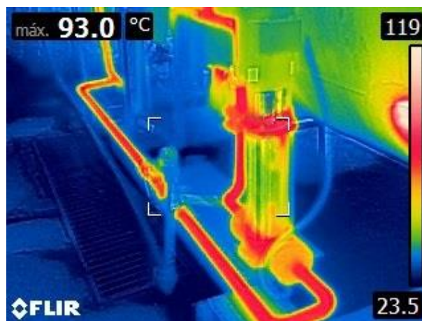
Figura G.0-3 – Fotografia térmica bomba + linha de água que entra na caldeira
