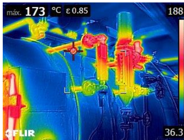
Figura G.0-1 – Fotografia térmica da caldeira (lateral)
