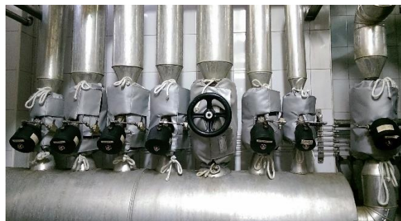
Figura 6-2 - Válvulas industriais com isolamento do tipo "camisa" aplicado (FONTE:[16])
