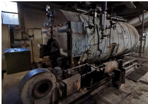
Figura 4-2 – Fotografia da caldeira utilizada nas instalações
