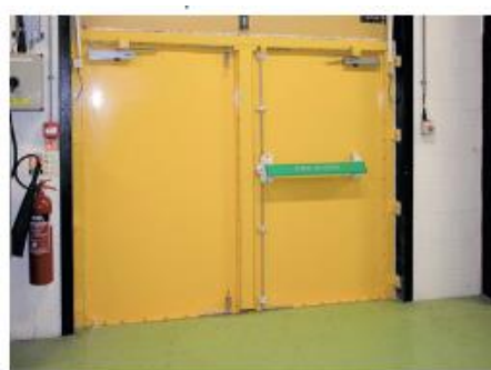
Portas anti-inundações com juntas
