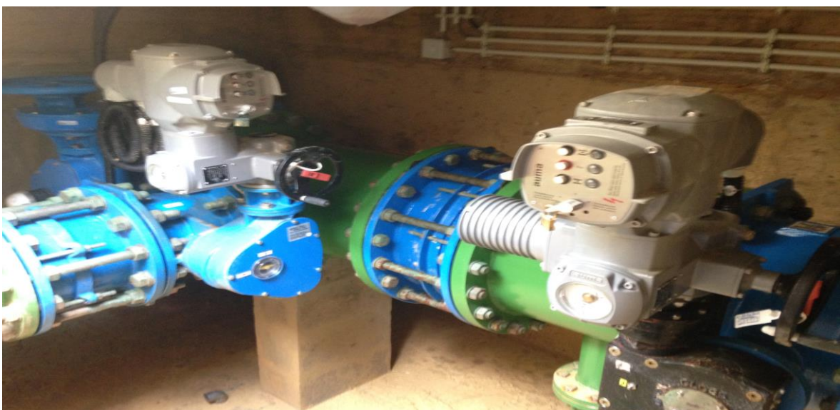
Figura 4.7 – Vista interior de uma Caixa de Derivação
