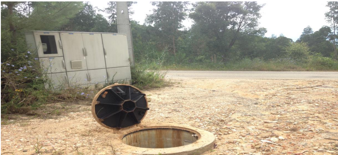
Figura 4.6 – Vista exterior de uma Caixa de Derivação
