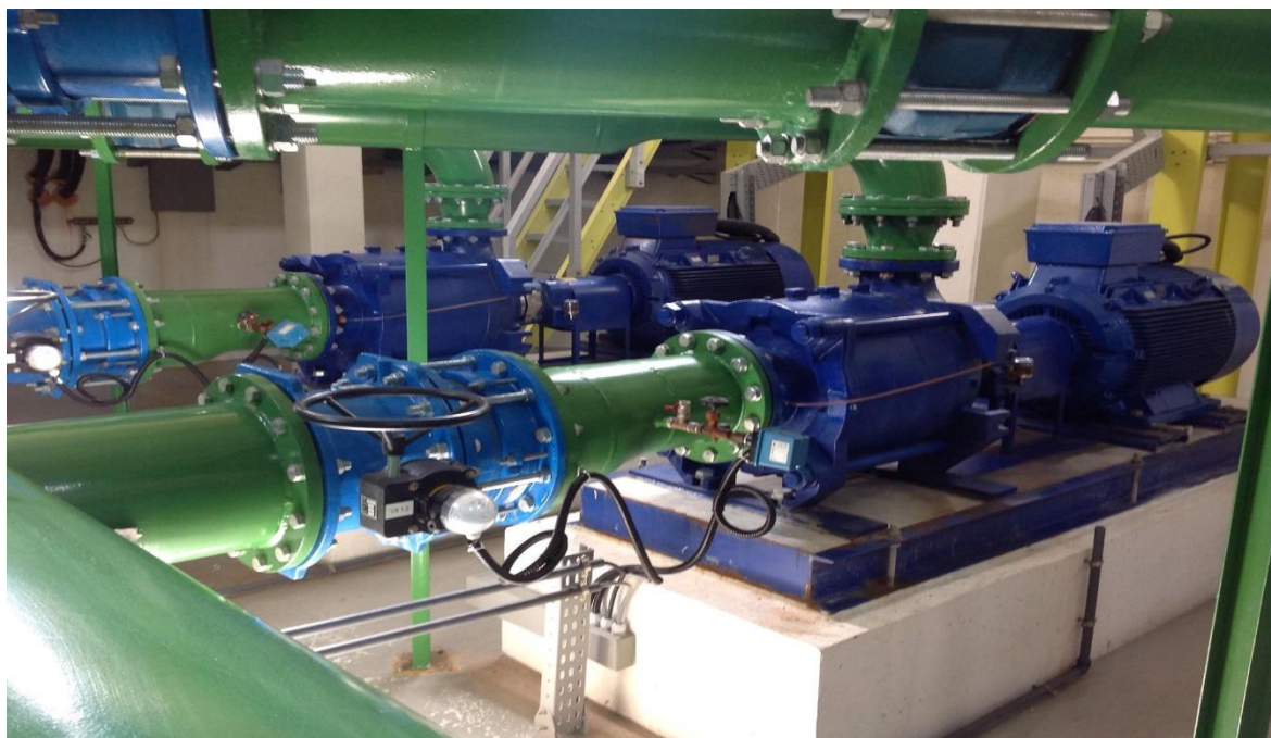
Figura 4.4 – Grupos Eletrobomba de uma Estação Elevatória
