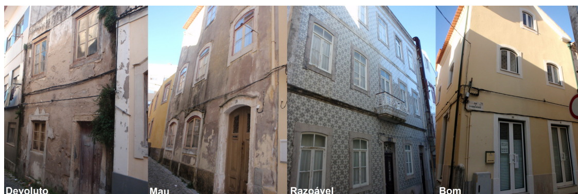
Figura 14- Caracterização do Estado de Conservação dos Edifícios
