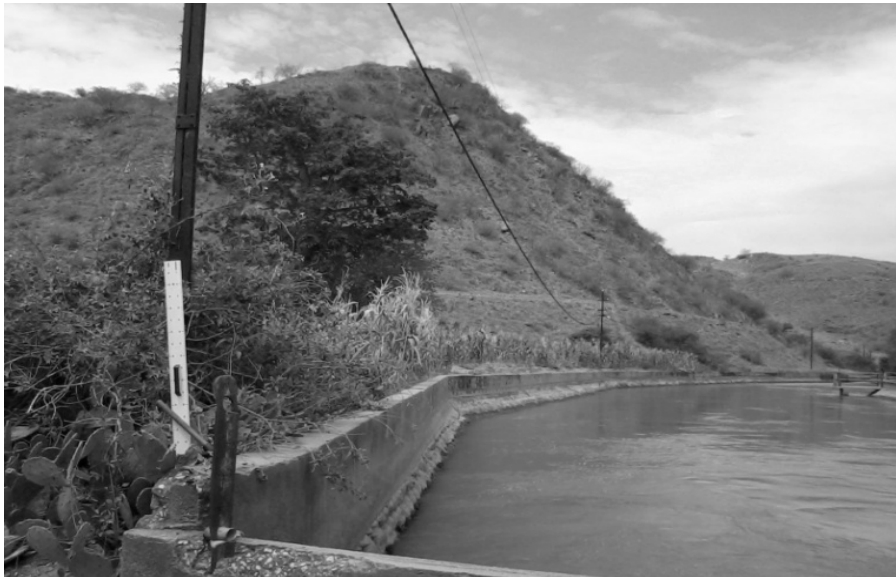
Figura 5.14 -Talude 8 junto à barragem e canal de adução às condutas forçadas da central hidroeléctrica.
