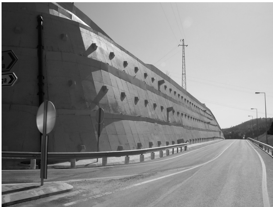
Figura 4.34 – Muro ancorado em Entre-os-Rios. Créditos fotográficos A. Saraiva.
