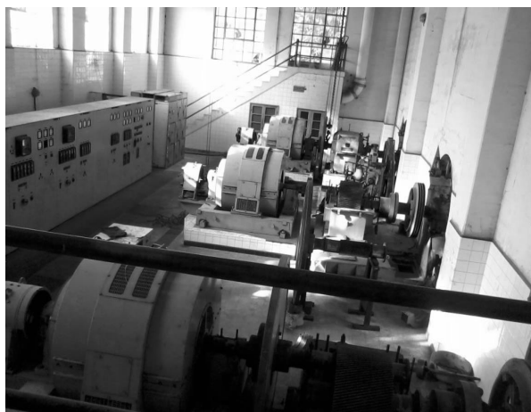
Figura 1.4 - Casa das máquinas da barragem na povoação do Biópio-Açucareira 1º de Maio S.A.R.L.
