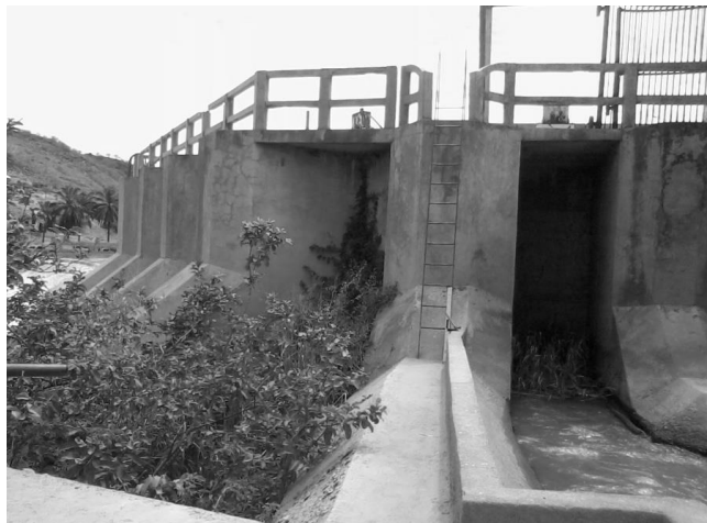
Figura 1.3 - Barragem hidroeléctrica na povoação do Biópio- Açucareira 1º de Maio.
