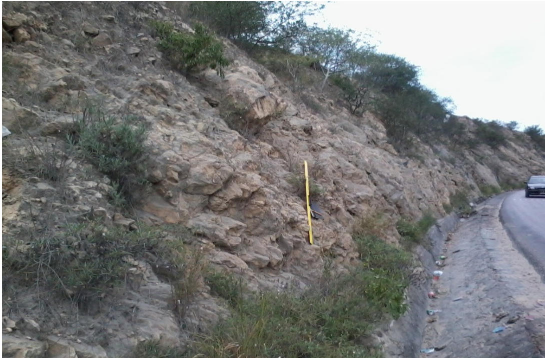
Figura 5.3 - Talude 2 ao longo da estrada Lobito Sumbe e/ ou Huambo.
