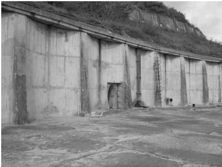
Figura 4.25 - Galeria drenante na encosta das Portas do Sol, Santarém. Créditos fotográficos A. Saraiva.
