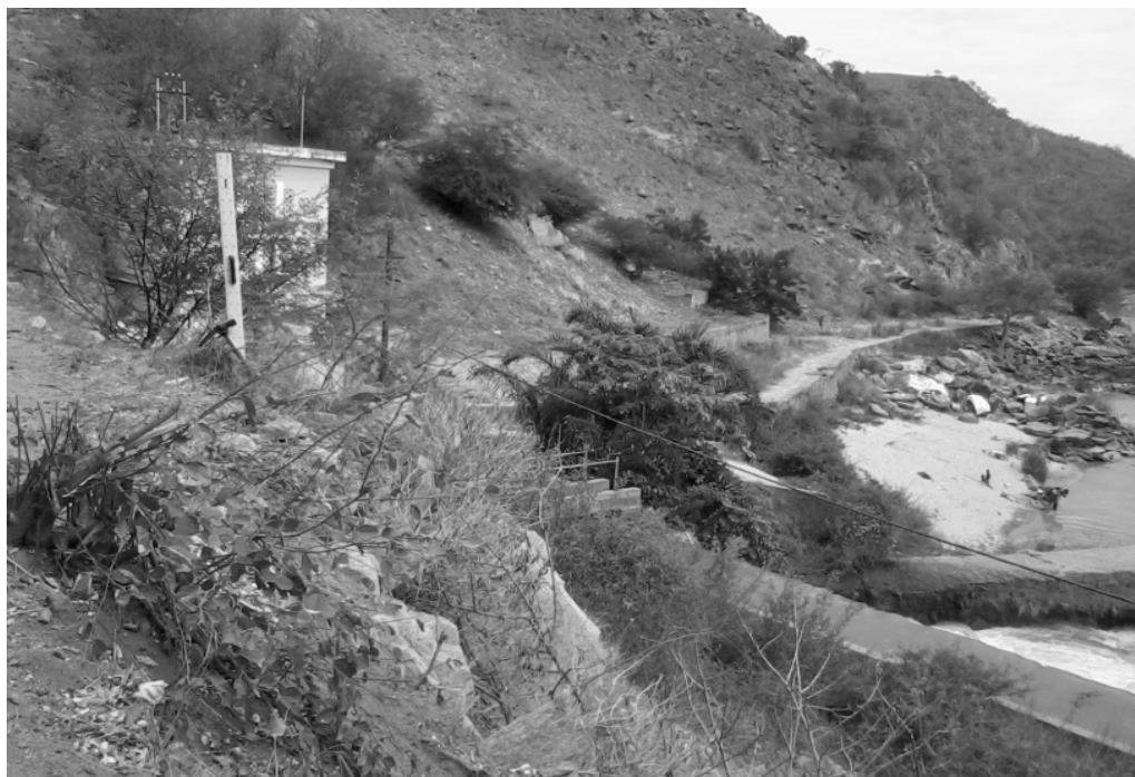
Figura 5.10 - Talude 7 na zona de captação de água para a central hidroeléctrica.
