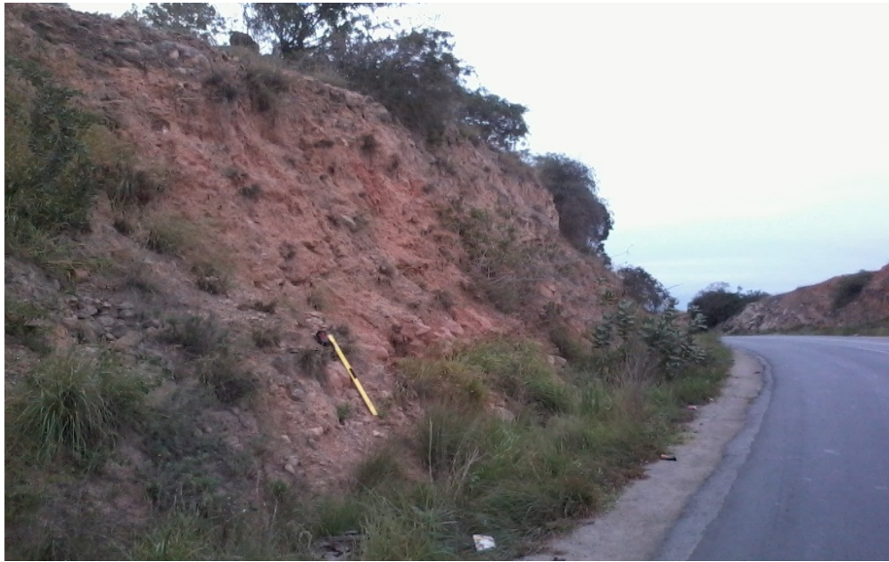
Figura 5.2 - Talude 1 ao longo da estrada Lobito Sumbe e/ou Huambo.
