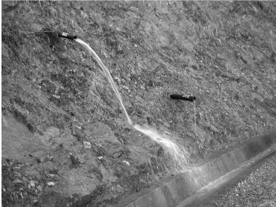
Figura 4.24 - Drenos na encosta da margem esquerda da barragem da Raiva. Créditos fotográficos A. Saraiva.
