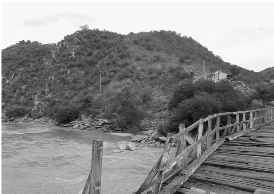
Figura 5.6 - Talude 4 junto à ponte da Povoação sobre o Rio Catumbela.
