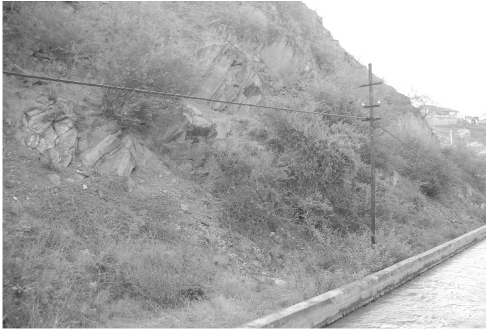
Figura 5.11 - Talude 7 junto ao canal adutor para a central hidroelétrica.
