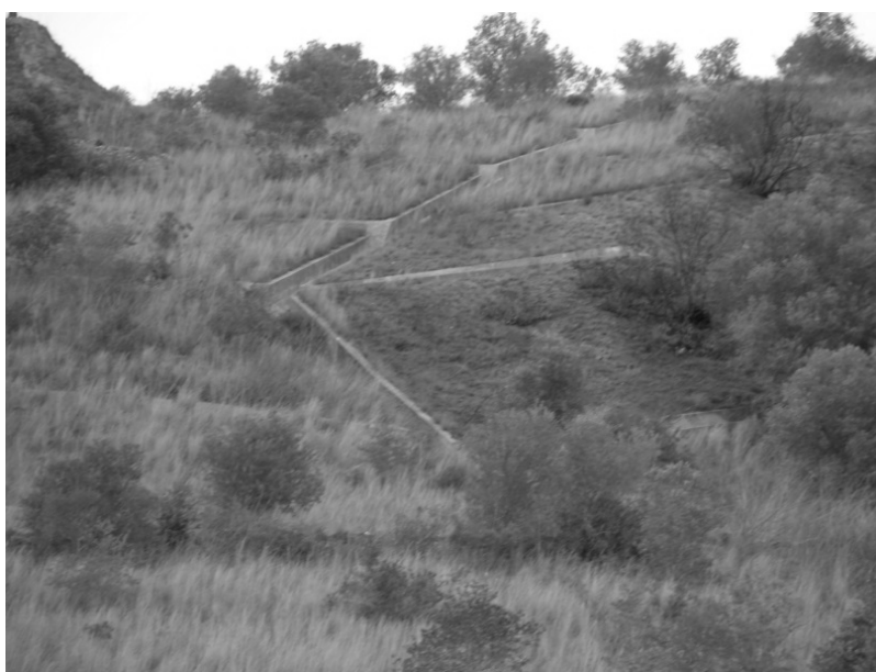
Figura 4.23 – Valetas drenantes nas Ómnias, Santarém. Créditos fotográficos A. Saraiva.
