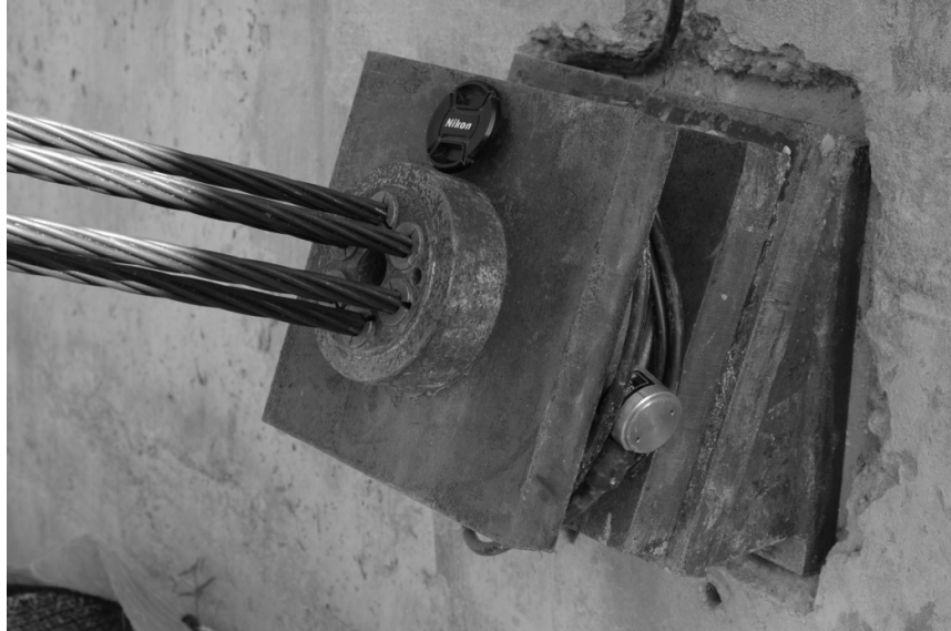
Figura 4.33 – Cabeça de ancoragem sem protecção. Créditos fotográficos A. Saraiva.
