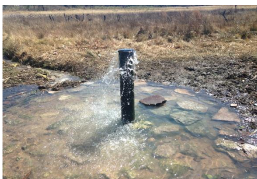
Fig. 2.19 – Equipamento ambiental na comuna Sede (furo de captação).
