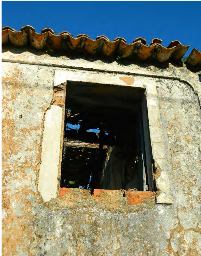
Figura 67 - Molduras da janela em calcário.
