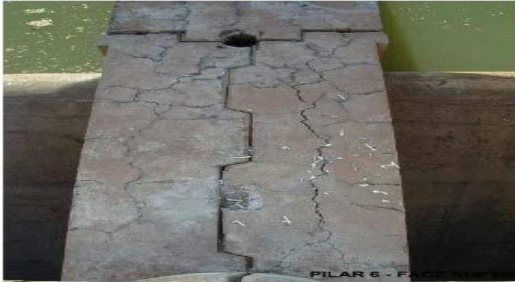
Figura 5.5 - Pilar da barragem antes da reabilitação (Batista e Gomes, 2014).
