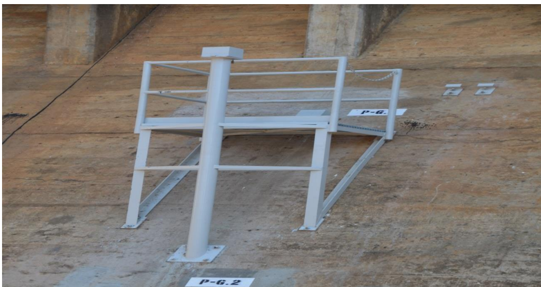
Figura 5.17 – Piezómetro instalado na barragem.
