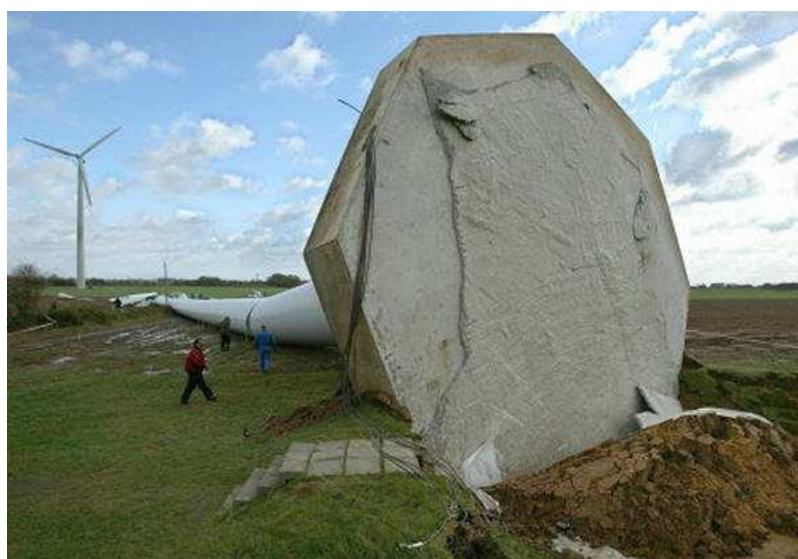
Figura 3.12- Torre eólica tombada devido ao incorreto dimensionamento das fundações (Ontario Wind Resistance, 2011)
