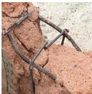
Figura 4.2 – Instabilidade da armadura de compressão observado na viga V\rho_{1,3} .
