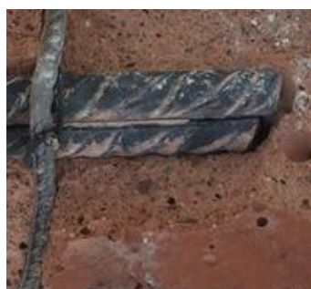
Figura 4.16- Escorregamento da armadura tracionada verificado na viga V4\phi 8 .
