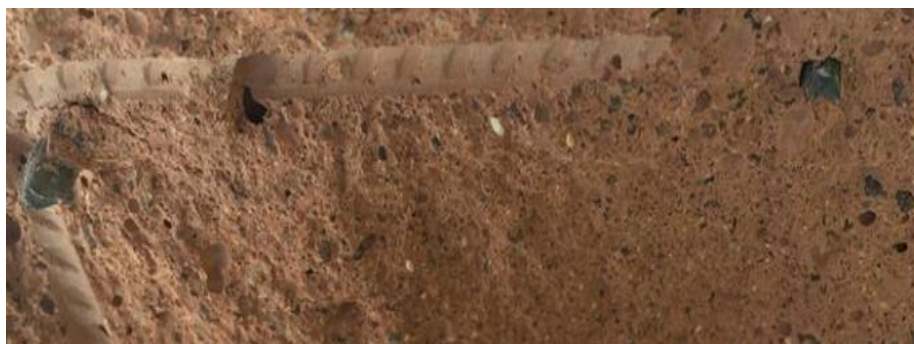
Figura 4.15- Rotura da armadura tracionada verificado na viga V2\phi 4 .
