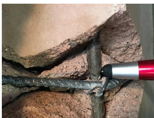
Figura 4.8 - Modo de rotura da Viga R62φ6.
