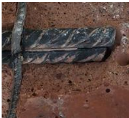
Figura 4.50 - Escorregamento das armaduras tracionadas da Viga \beta 4\phi 8 .
