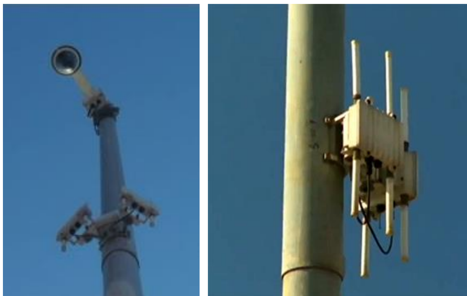
Figura 4.8 – Sensor acústico colocado num poste de iluminação (retirado do GOOGLE@, 2016)
