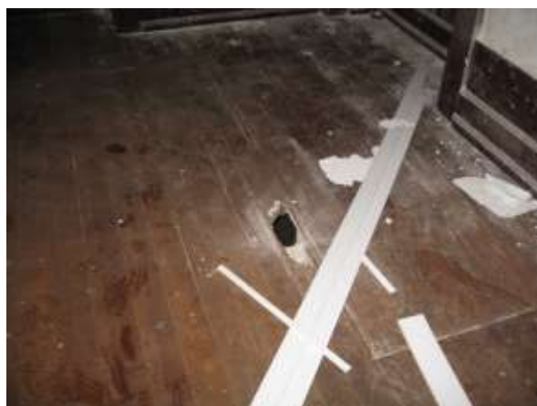
Figura 13 – Piso de madeira com buraco.
