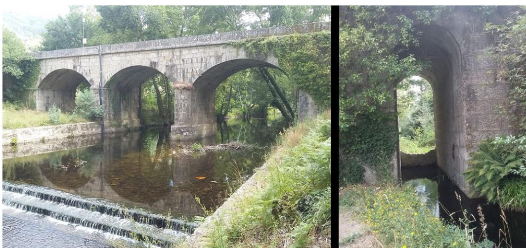
Figura 21: Ponte de São Gião (esquerda) e Arco da Ponte de São Gião (direita)
