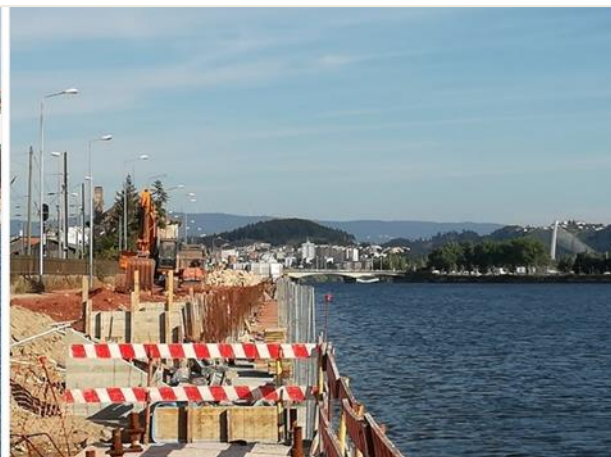
Figura 123 – Margem direita do rio, entre a ponte Sta. Clara e o Açude – ponte, com obras de intervenção na margem do rio
