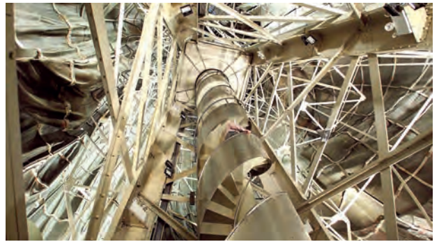
9. Foto atual do interior da Estátua da Liberdade, com vista da escada central helicoidal e estrutura de suporte.
