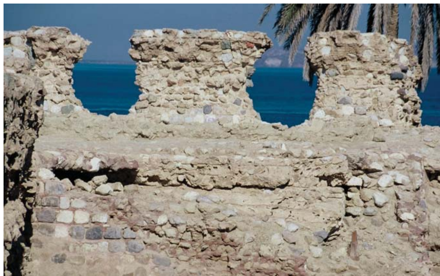
Baluarte Norte / Nascente, vendo-se o estado dos merlões e das embocaduras das canhoneiras. Na parte inferior nota-se a diferente condição da alvenaria, correspondente à compleição inicial do Forte quinhentista.
