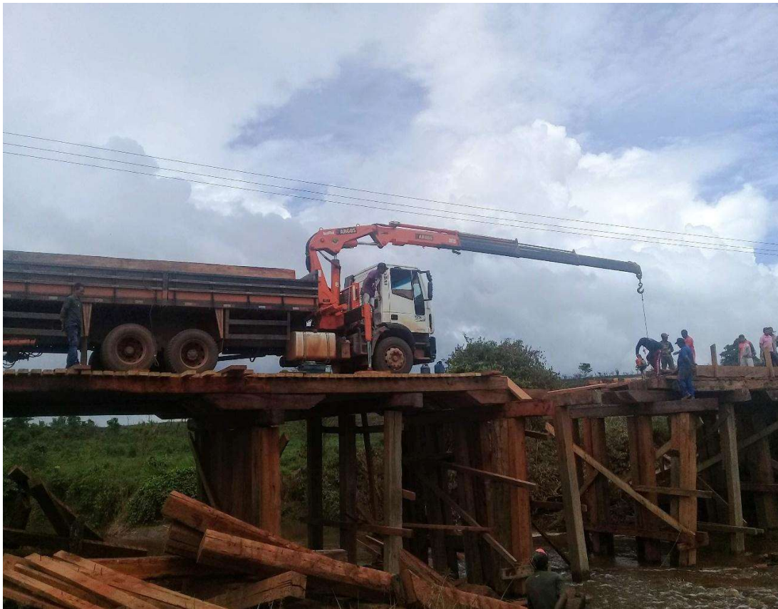
Figura 15 - Trabalhadores sem Equipamento de Proteção Individual
