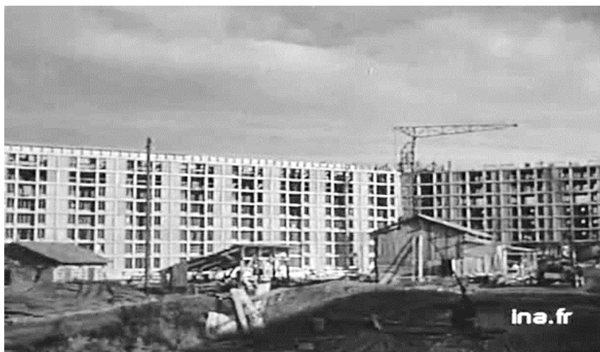
Figura 7 - Vista geral da fase de construção da cité Rotterdam, em Estrasburgo, primeiro conjunto deste tipo construído nos anos após-guerra, para alojamento de urgência nesta região oriental do país (800 habitações / 2.000 habitantes) (1951-1953), projeto de Jean Dubuisson e Eugène Beaudouin.
