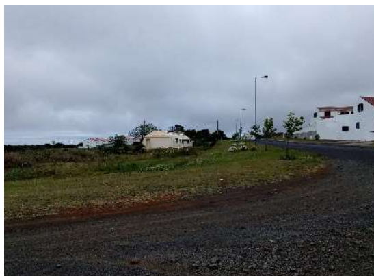
Figura 4.89 – Aspetos da Degradação das Vias de Circulação Automóvel (Fotos da Autora)
