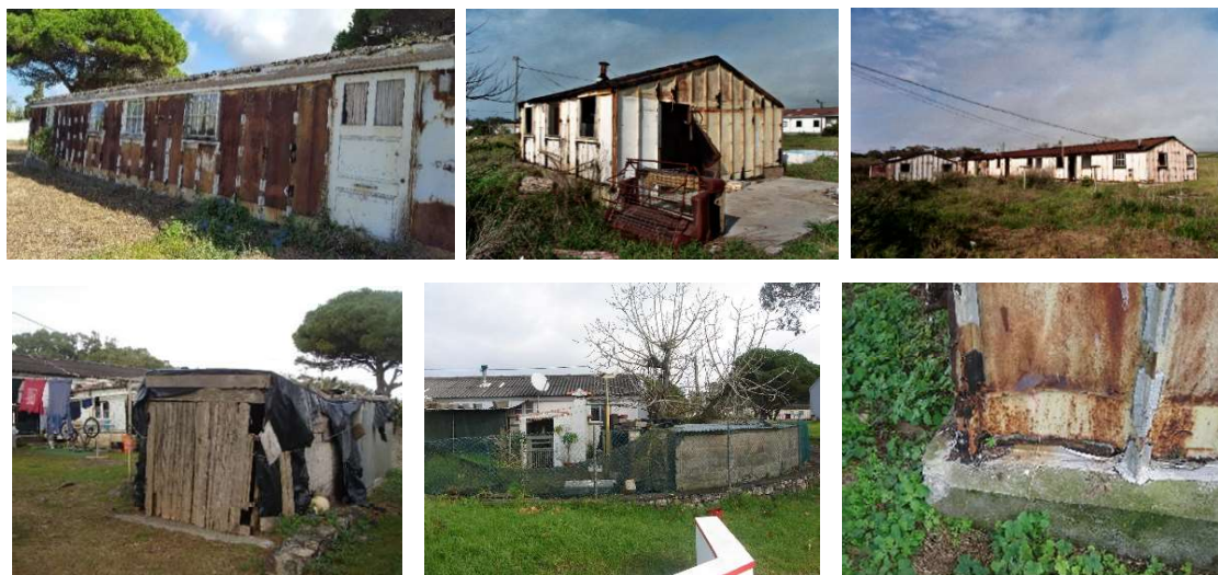
Figura 4.56 – Aspetos da Degradação das Construções Metálicas( Fotos da Autora)
