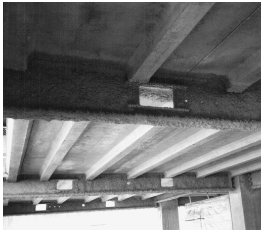
Figura 2.2 - Proteção com materiais projetados numa viga metálica que suporta uma laje de betão pré-fabricada [5]
