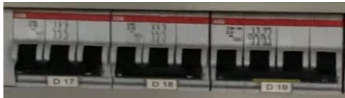
Figura AP. 11 Disjuntores do GTA III.
