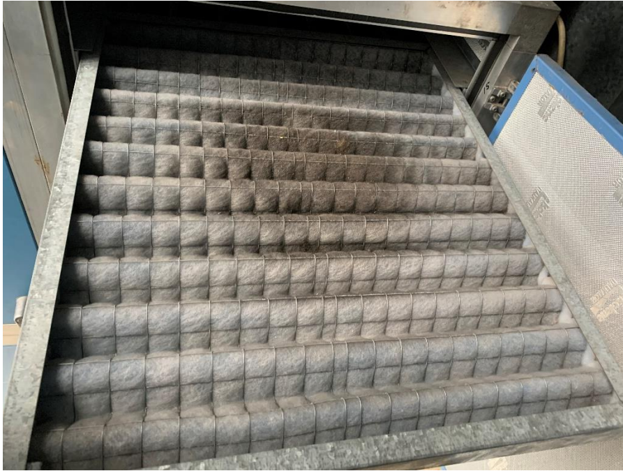
Figura 4.7 Pré-filtro danificado do GTA III.
