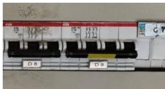
Figura AP. 7 Disjuntores do GTA II.
