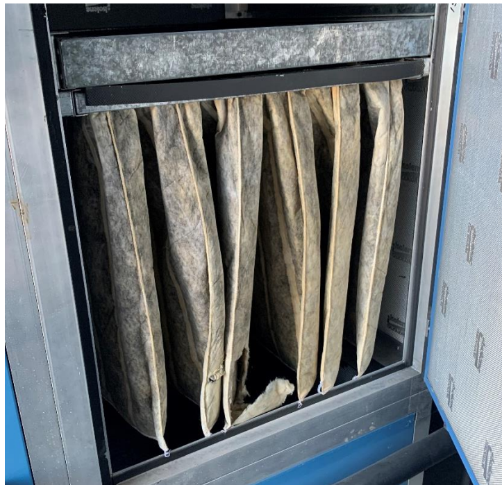
Figura 4.8 Filtro de bolsa danificado.
