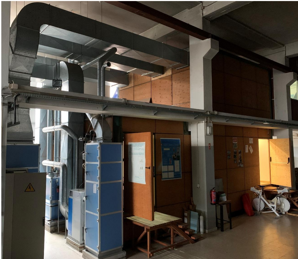
Figura 4.14 CC e respetivo sistema de AVAC.
