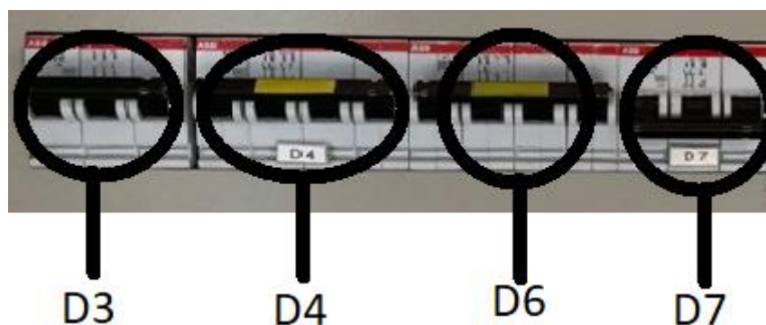
Figura AP. 5 Disjuntores do GTA I.
