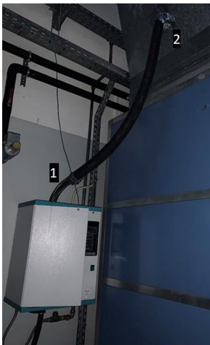
Figura 4.13 Ligação entre humidificador e conduta de insuflação do GTA I. (1 – saída da mangueira do desumidificador; 2 – Entrada da mangueira na conduta de insuflação do GTA I)
