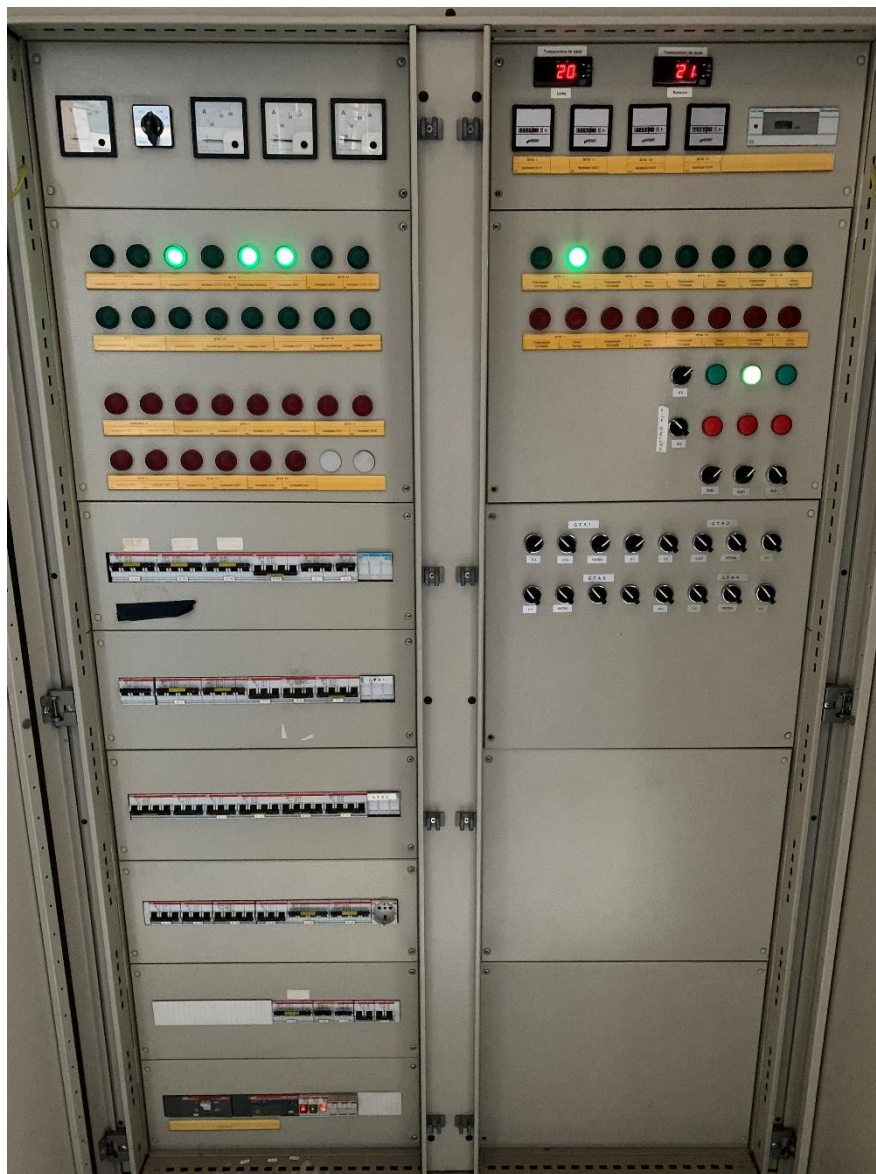
Figura 4.2 Quadro elétrico do sistema de AVAC.
