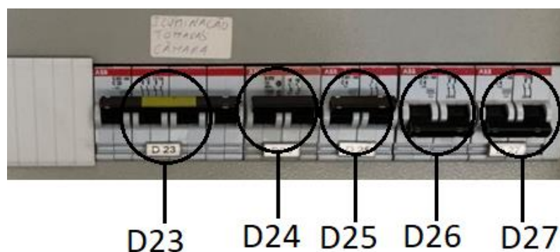
Figura AP. 3 Disjuntores respetivos à CC.
