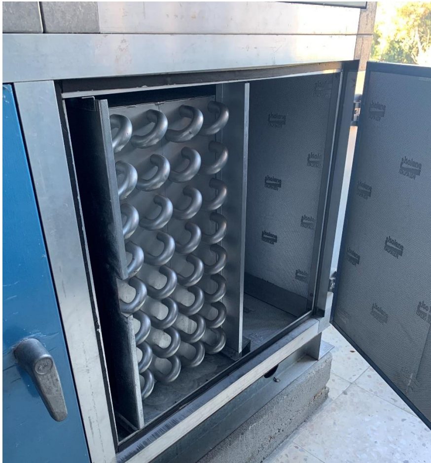
Figura 2.5 Baterias de arrefecimento da UTA.
