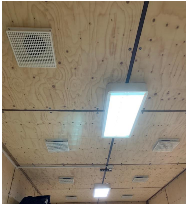
Figura 4.18 Difusores de insuflação na sala de controlo da CC.
