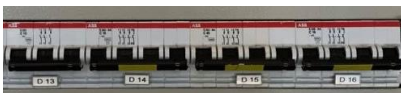
Figura AP. 10 Disjuntores do GTA III, humidificador e desumidificador.
