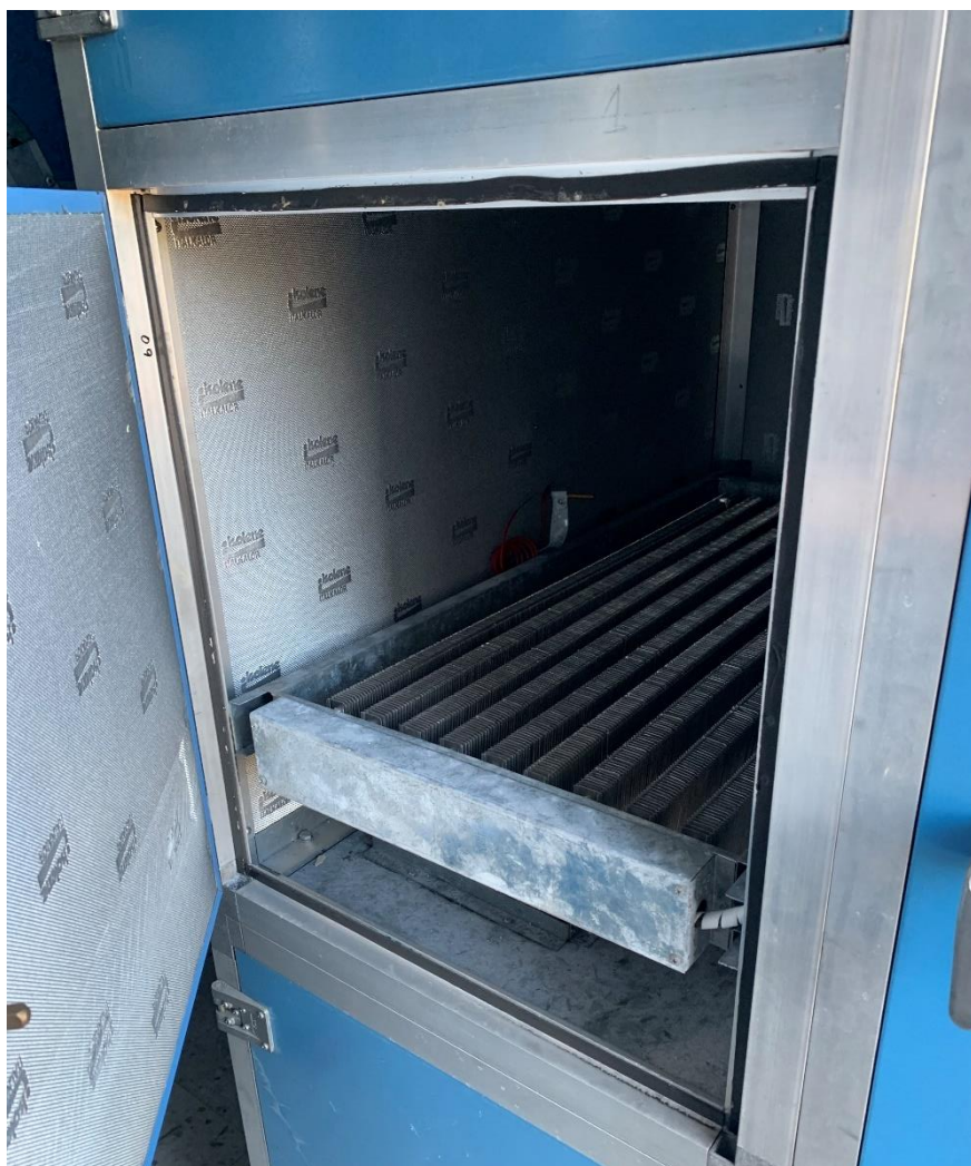
Figura 2.4 Resistências de aquecimento da UTA.
