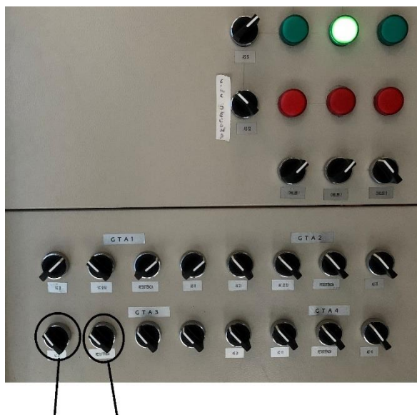
Figura AP. 12 Interruptores do GTA III.
