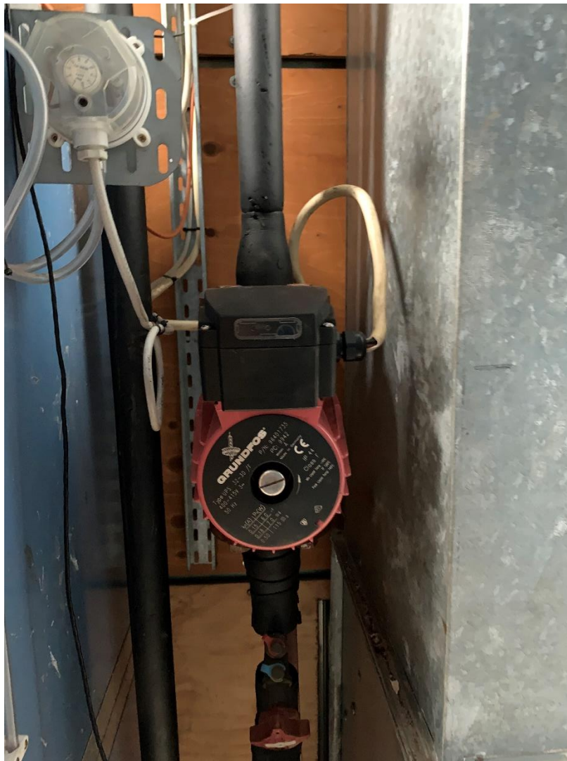
Figura 4.6 Bomba de circulação nova instalada.
