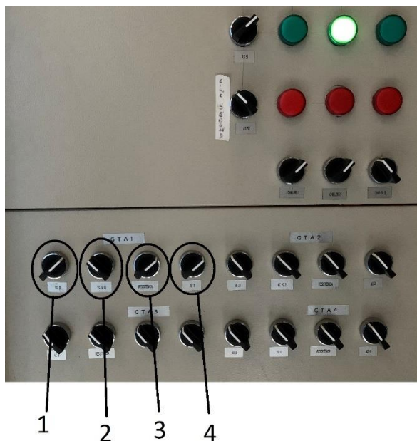
Figura AP. 6 Interruptores do GTA I.
