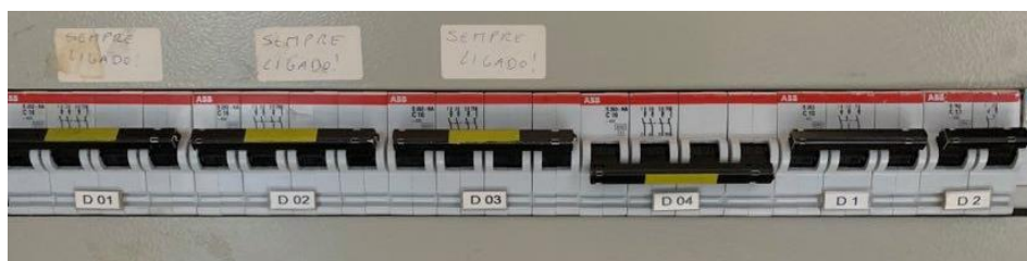
Figura AP. 13 Disjuntores do grupo frigorífico.
