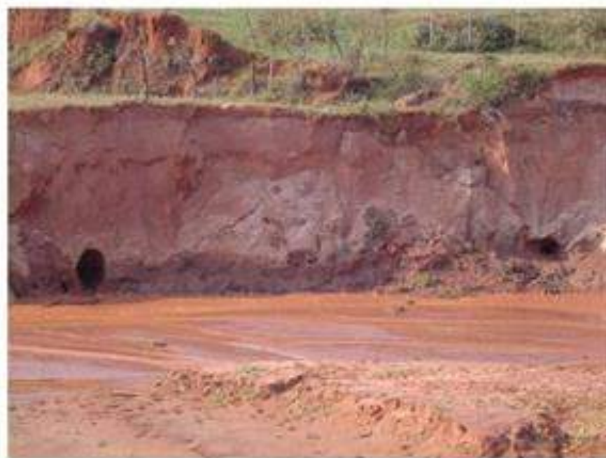
Figura 14: Formação de orifício na base do talude, devido à concentração de água do lençol freático (fenômeno de piping ), no município de Paraguaçu-Paulista (SP). Fonte: IPT, 2013
