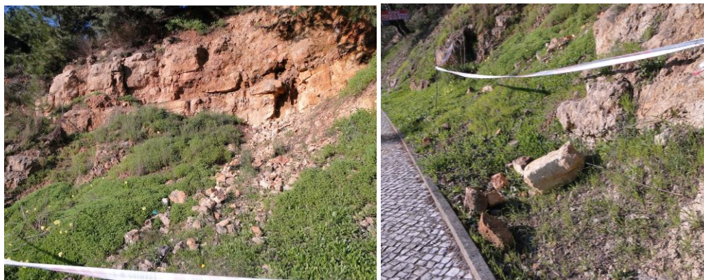
Fig. 2.11 – Zona D sinalizada, após desprendimento de blocos
