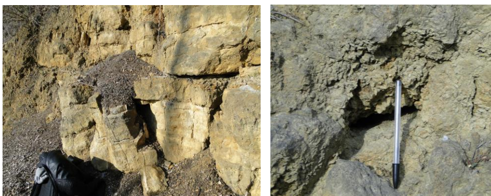
Fig. 2.15 – Condições do maciço rochoso na base do talude
