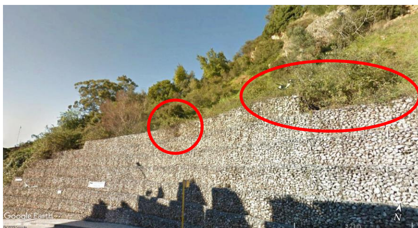
Fig. 5.1 – Vista do Google Earth para o muro de gabiões localizado na Zona M
