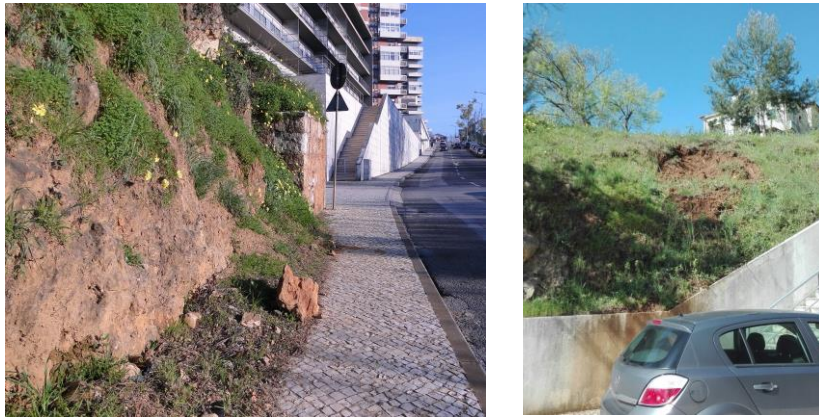
Fig. 2.4 – Registo fotográfico de quedas de blocos e deslizamentos
