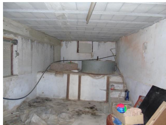
Figura 208 - Sala extra com capacidade para duas microturbinas no moinho do Pombal
