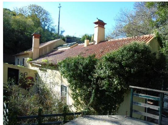
Figura 125 - Desgaste natural devido ao abandono do edifício
