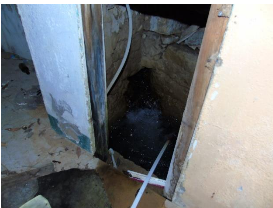
Figura 127 - Canal de água para o funcionamento hidroelétrico
